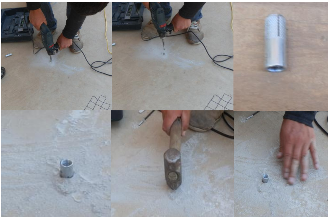
Imagen N° 18: Colocado del taco de expansión en el pavimento del P7, Cuadra 1 del Jr. Japón.
