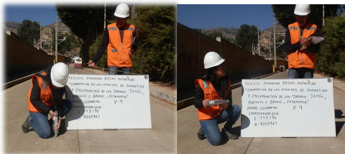
Imagen N° 14: Ensayo de Esclerometría P-9 - Cuadra 1 del Jr. Portugal
