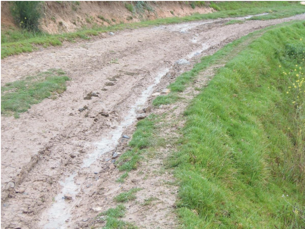
Fotografía N° 11 Mal estado de la carretera
