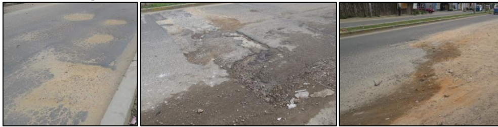
Figura 7: Superficie dañada de la infraestructura vial.
