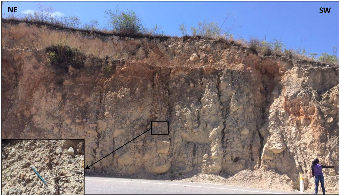
Foto N° 15: Talud suspendido con presencia de rocas por deslizarse; constituido por conglomerado de areniscas en una matriz arenosa,
