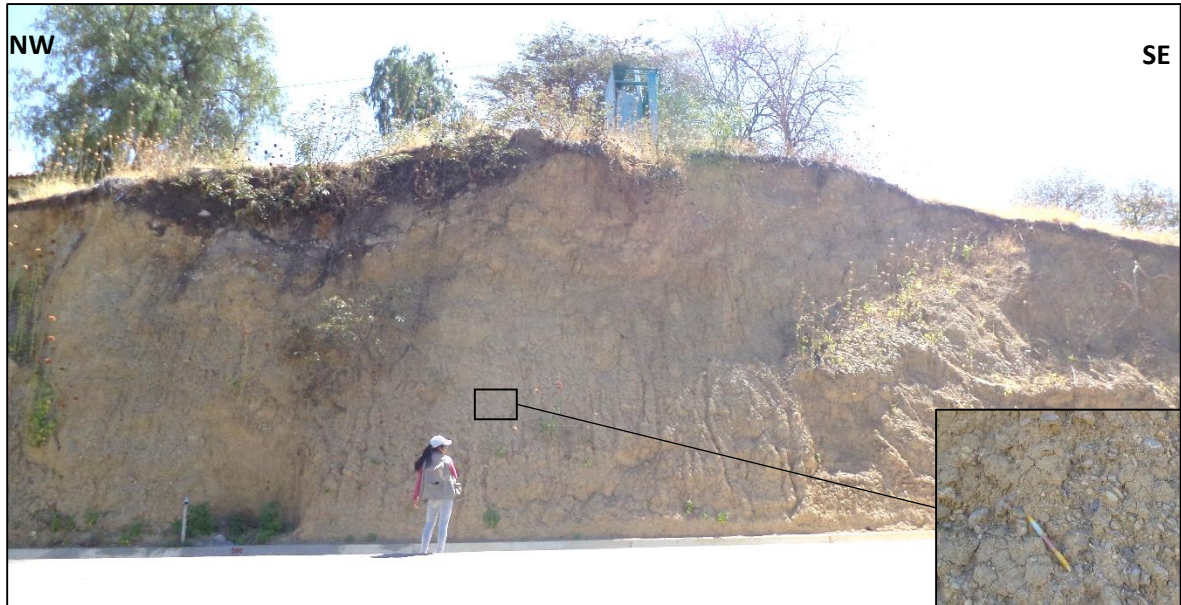
Foto N° 12: Talud suspendido con presencia de masa deslizada; constituido por clastos de areniscas y clastos calcáreos en una matriz arenosa.
