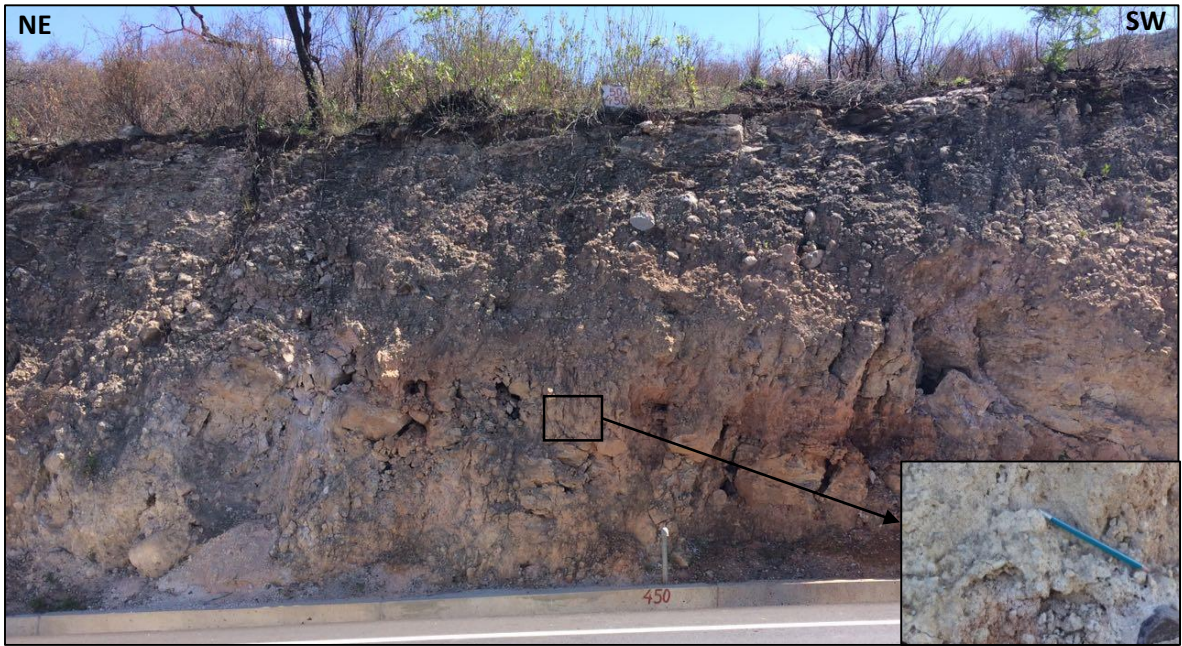
Foto N° 18: Talud suspendido con presencia de cárcavas en conglomerado fino de areniscas en una matriz de arcilla calcárea.
