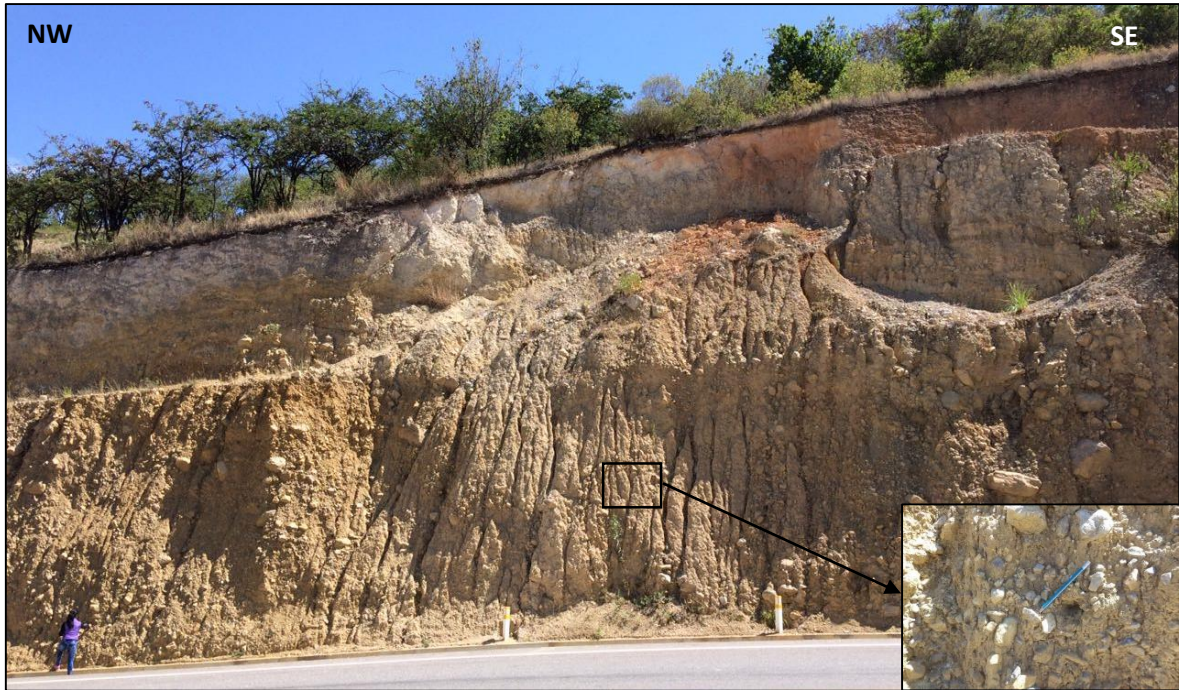
Foto N° 16: Talud suspendido con presencia de pequeñas cárcavas provocadas por la lluvia; constituido por conglomerado de areniscas y clastos calcáreos en una matriz arenosa.
