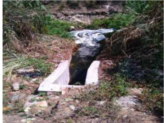
Foto 02: Dispositivo de salida de aguas residuales.
