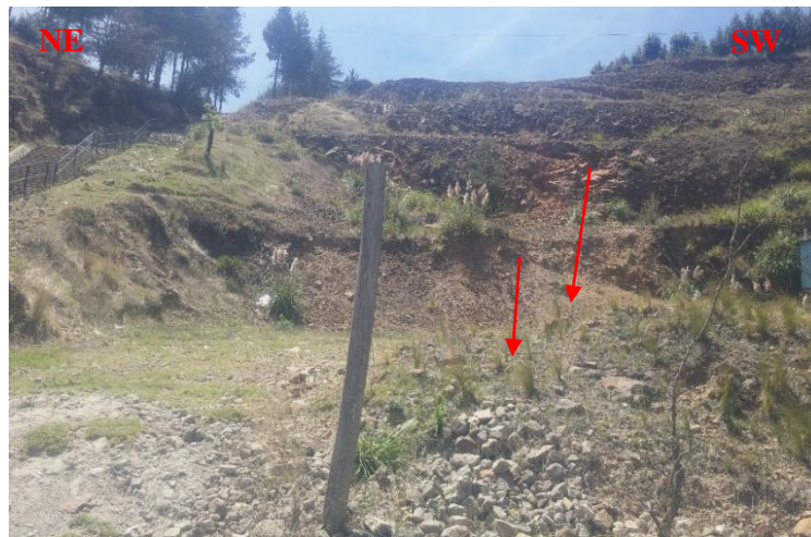
Figura 44: Caída de Rocas, ubicado en margen derecho de la carretera a Porcón Alto; en el caserío de Hierba Buena. Referencia Km. 0 + 750.
