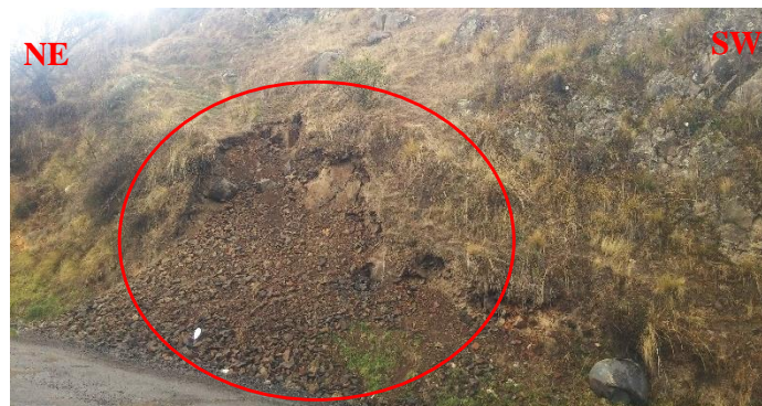
Figura 47: Deslizamiento de rocas fracturadas, ubicada en el corte de carretera hacia Porcón Alto, margen derecho; Caserío de Porcón Alto. Referencia Km. 0 + 850.
