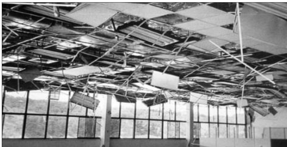
Figura 2.5. Daños en cielos rasos
