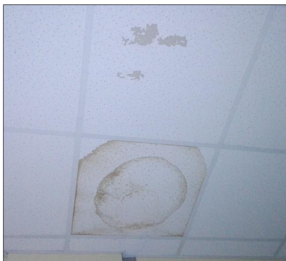
Figura 3.18. Estado del cielo raso en el 2 do piso del Sector E
