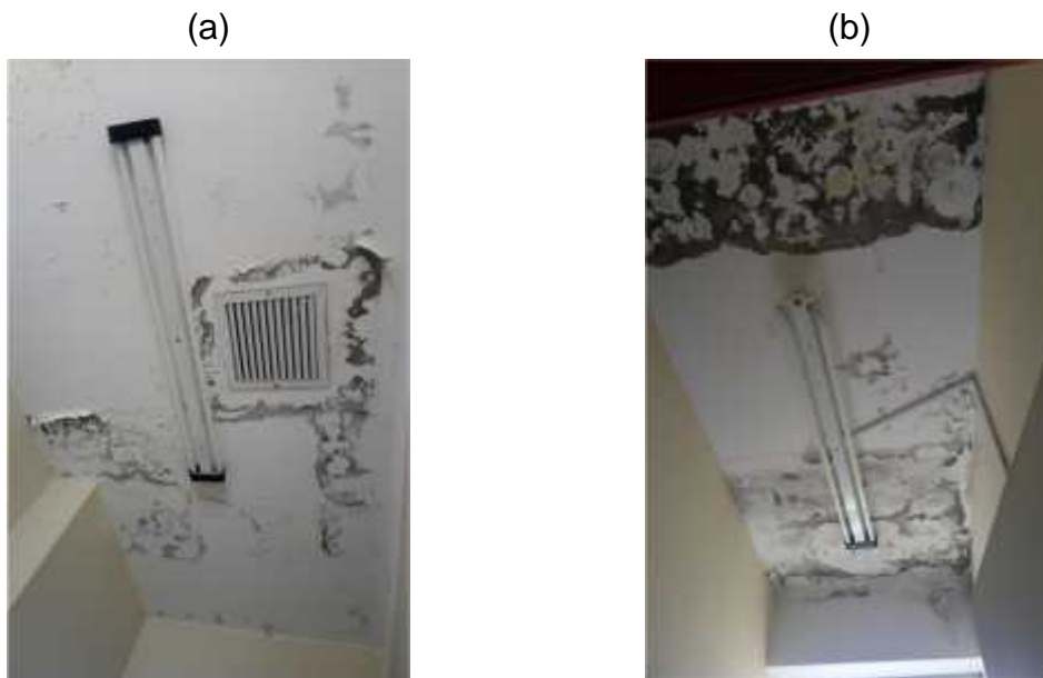
Figura 3.6 Humedad en losa del segundo piso del Sector B
