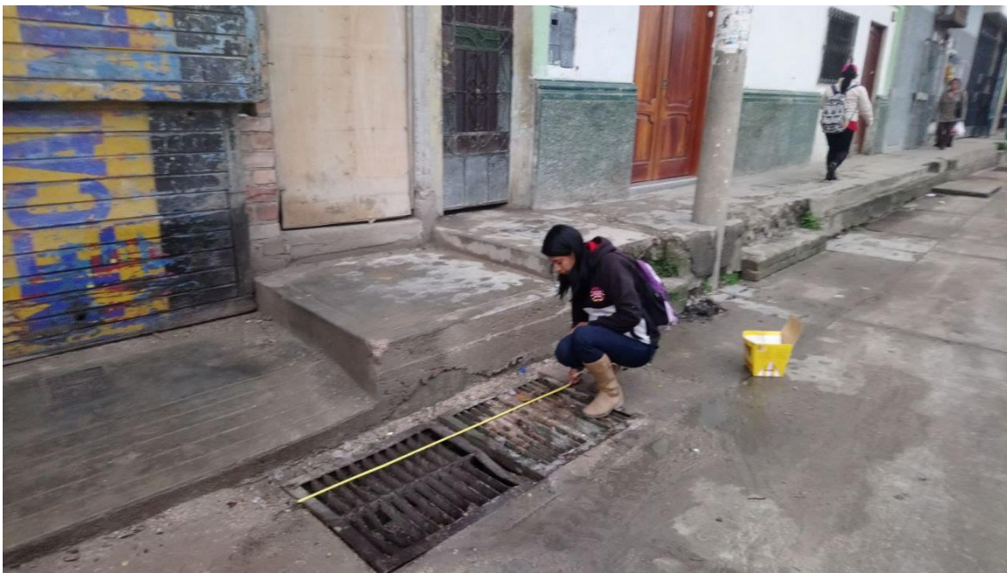
Fotografía N° 16: Yo, realizando la medición de la alcantarilla ubicada en la calzada del segmento I; así mismo, se aprecia que las aceras están a desnivel.
