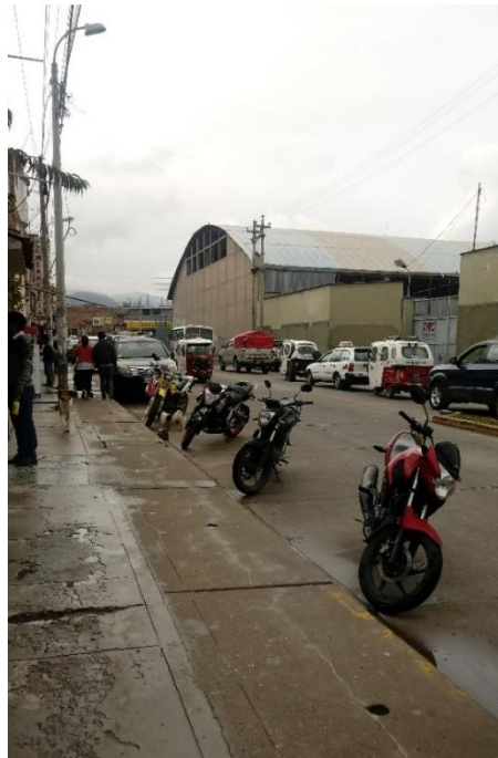
Fotografía N° 12: Vehículos estacionados en la calzada del Segmento I, se observa que la acera se encuentra con grietas.
