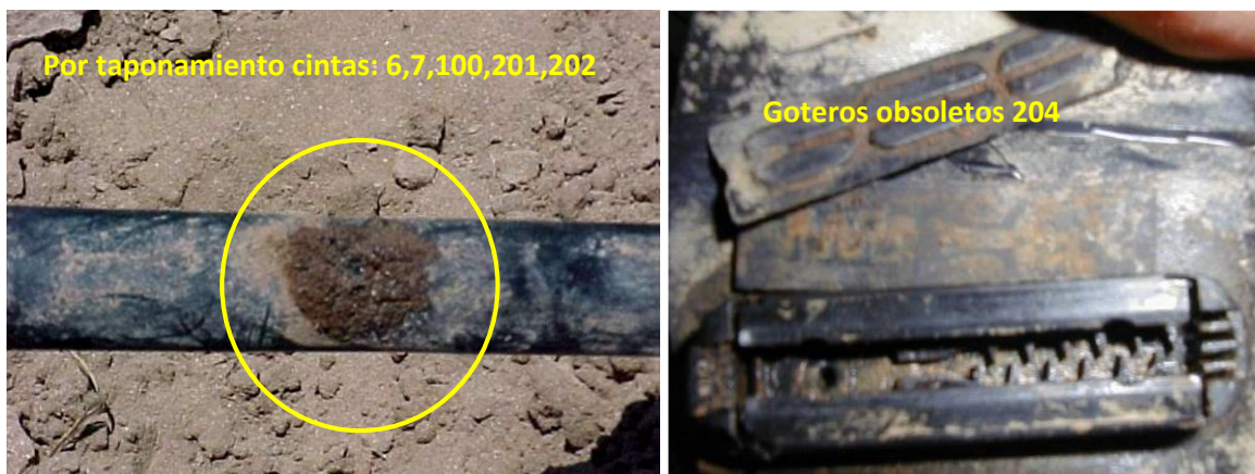
Figura 20. Taponamiento de goteros por sedimentos
