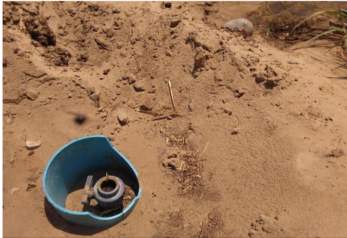
Foto 4. Estado de abandono de las válvulas de aire de la tubería de distribución
