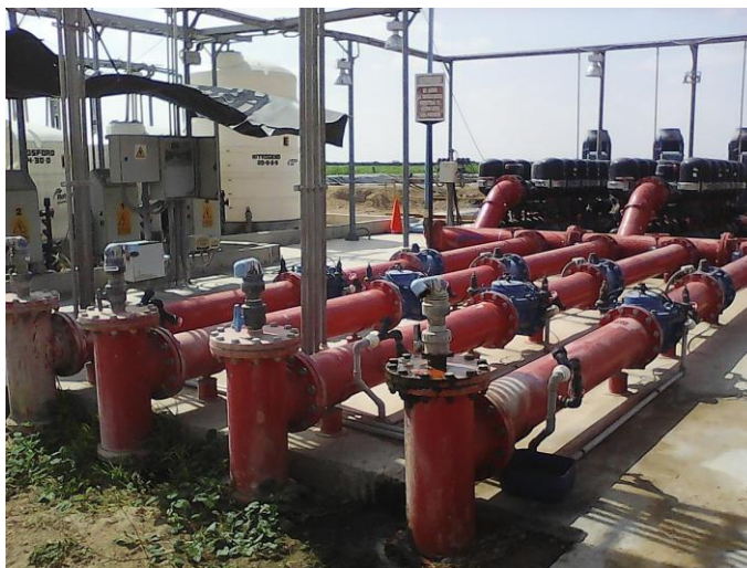
Foto 6. DPS10, Tuberías de conducción del micro reservorio hacia los blocks.
