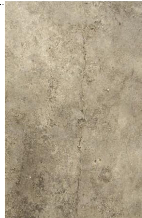
Losa aligerada agrietada
