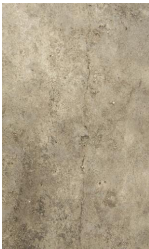
Losa aligerada agrietada
