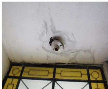
Filtraciones en cielorraso ocasionando efflorescencia
