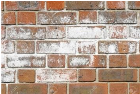
Figura 19. Muro de ladrillo con eflorescencia
