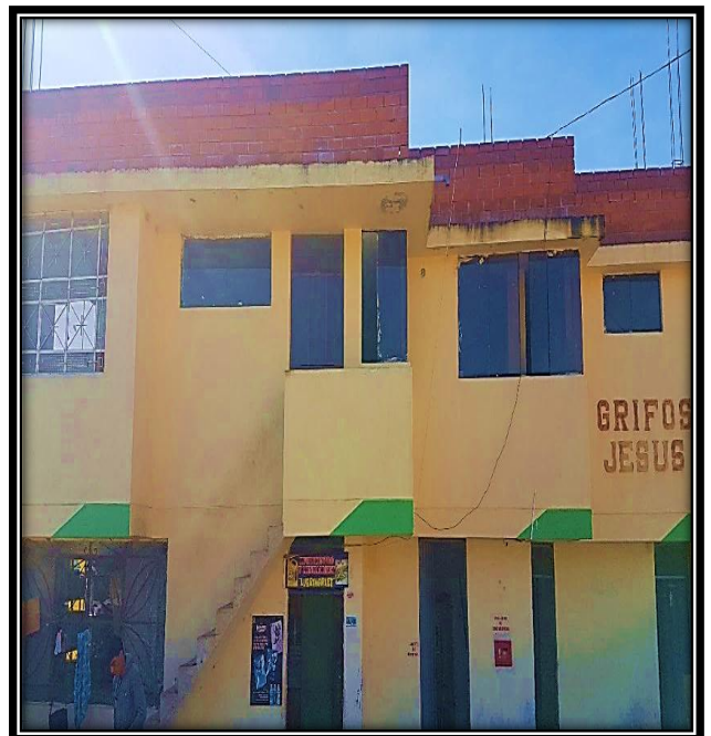
Figura N° 27 Problema de uniformidad en planta y elevación - Jesús
