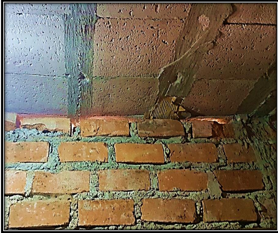
Figura N° 36 Tabiquería sin confinar
