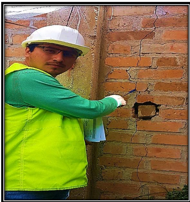
Figura N° 30 Grieta en muro por asentamiento diferencial
