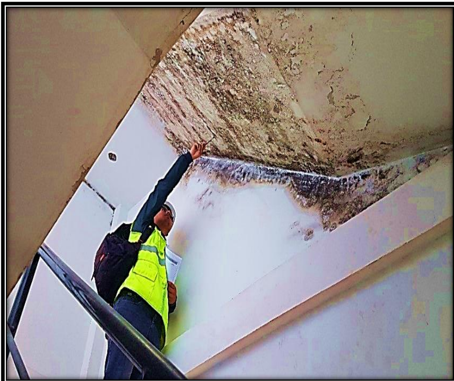
Figura N° 37 Humedad en losa y escalera
