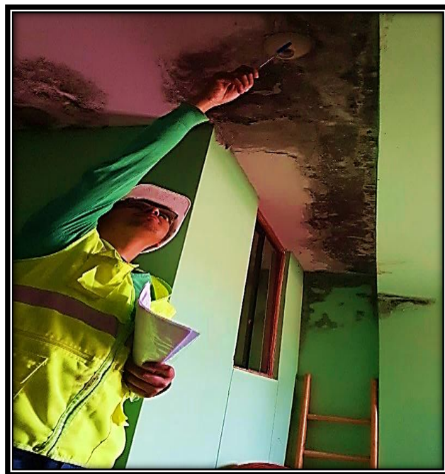
Figura N° 29 Presencia de humedad en losa y punto de luz
