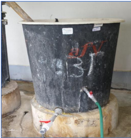
Figura 11: Depósito para preparar la solución de coagulante
