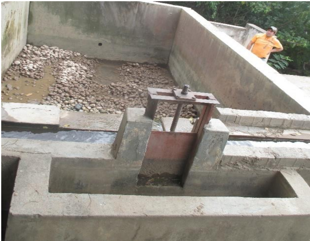
Figura 19. Filtros de canto rodado para el agua que consume la población de Balzas - Amazonas
