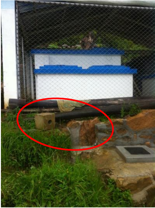
FOTO 19: Dado de concreto separado de tubería de limpieza/rebose.
