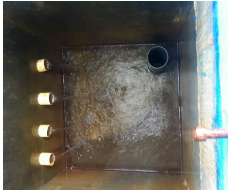
FOTO 12: ingreso de agua por los llorones (4) que descargan agua en la cámara húmeda.
