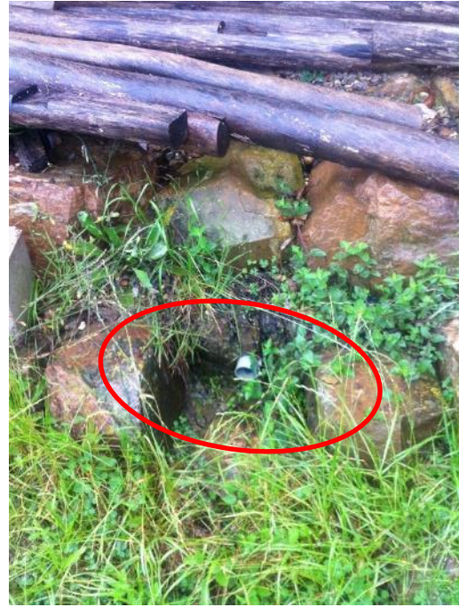
FOTO 20: Dado de concreto separado de tubería de limpieza/rebose.
