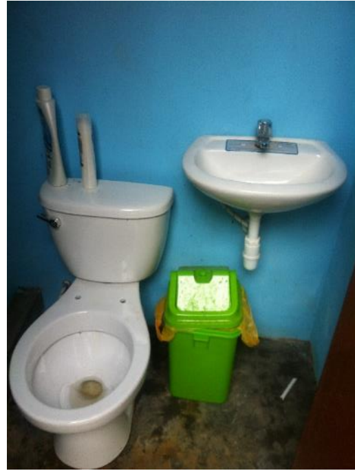
FOTO 28: Servicios Higiénicos en buen estado.
