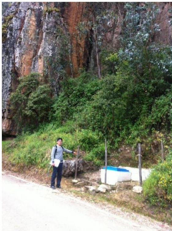
FOTO 9: Riesgo de desprendimiento de rocas en captación La Cortadera
