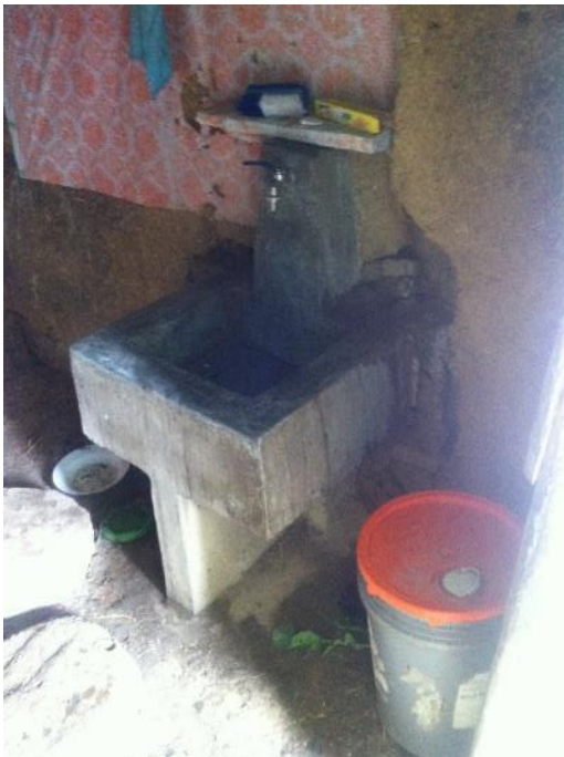
FOTO 29: Pileta instalada dentro de vivienda. En buen estado.
