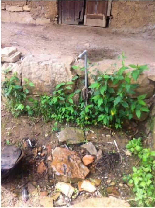
FOTO 27: Pileta sin estructura de concreto.
