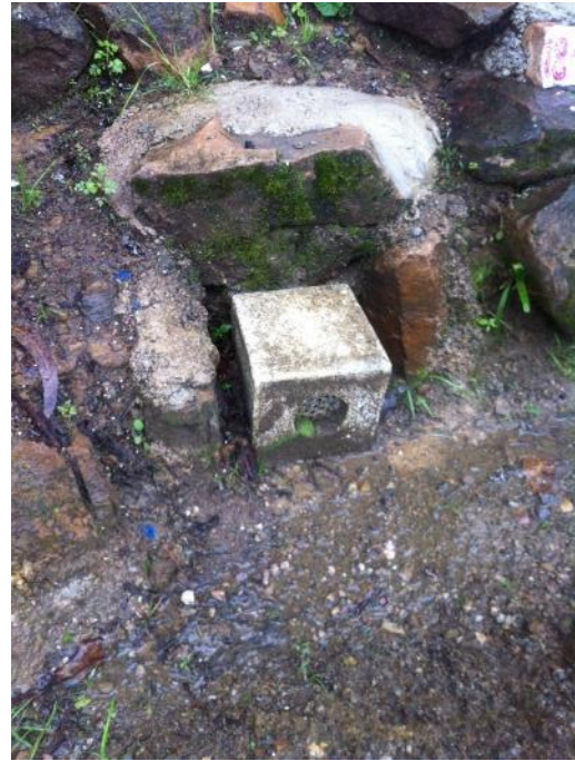
FOTO 2: Dado de Concreto en mal estado.
