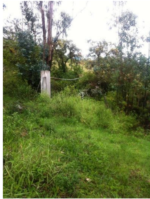
FOTO 31: Pase aéreo en Red de Distribución.
