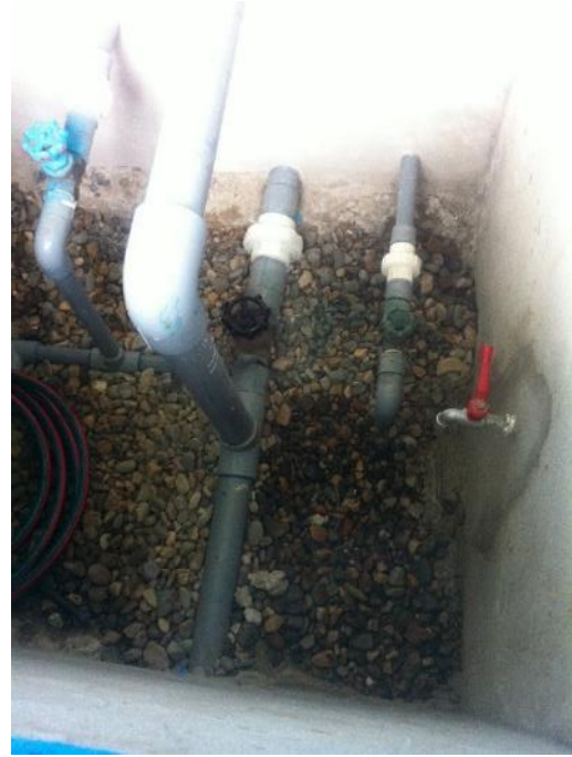
FOTO 16: Caja de válvulas del reservorio de concreto
