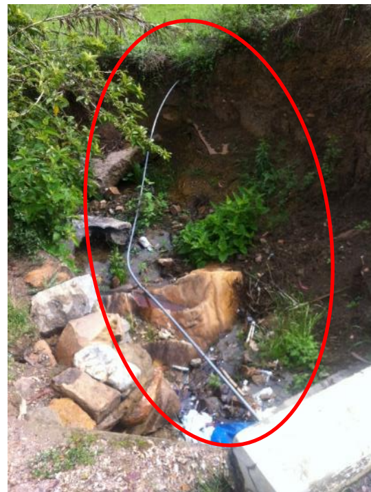
FOTO 26: Tubería de la Red de Distribución que pasa por una quebrada seca, descubierta totalmente.
