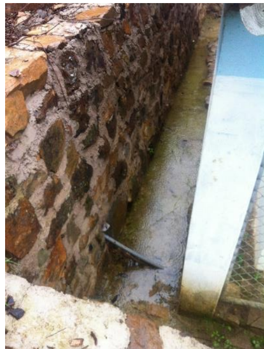
FOTO 14: Tubería de conducción, ingreso a Reservorio.
