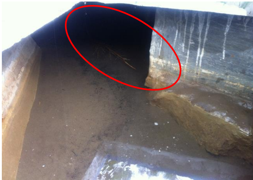
FOTO 7: Evidencia de raíces dentro de la captación El Higuérón.
