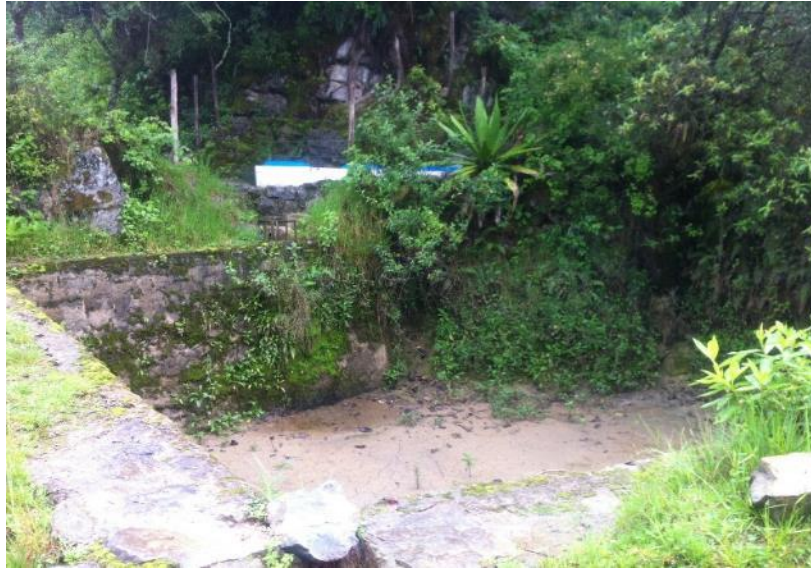
FOTO 8: Riesgo de desprendimiento de rocas en la Captación Higuerón
