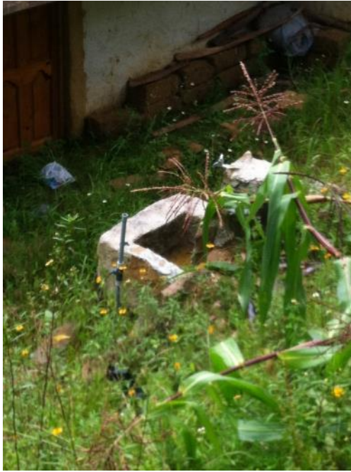
Pileta domiciliaria sin grifo, ni pedestal de concreto.
