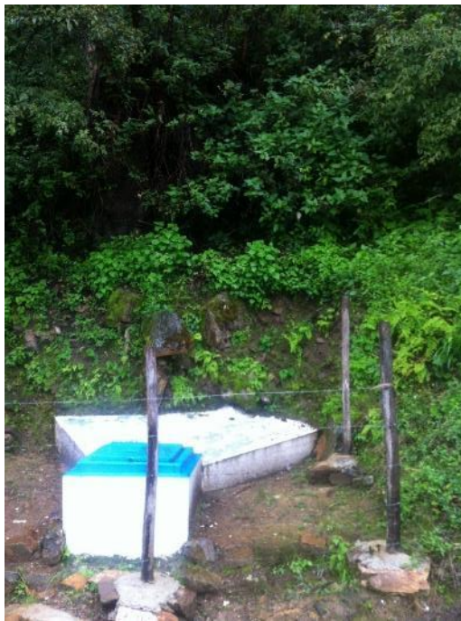
FOTO 3: Riesgo de derrumbes 1.
