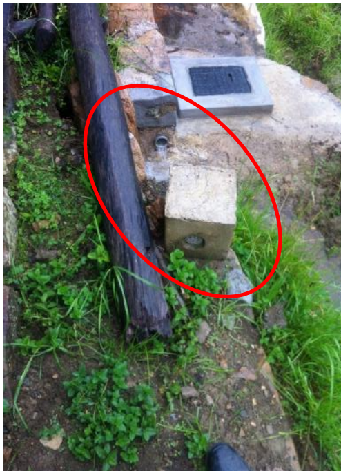
FOTO 21: Dado de concreto separado de tubería de limpieza/rebose.
