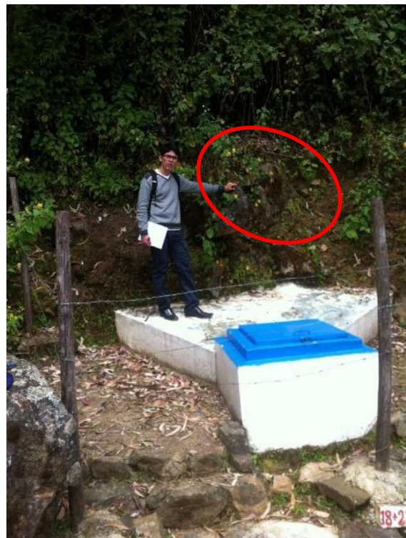
FOTO 10: Riesgo de desprendimiento de rocas en captación La Cortadera
