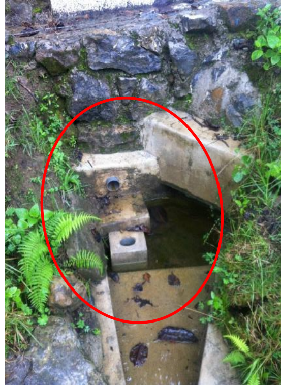
FOTO 6: Dado de Concreto en mal estado – separado de tubería de limpieza/rebose de la captación El Higuérón.
