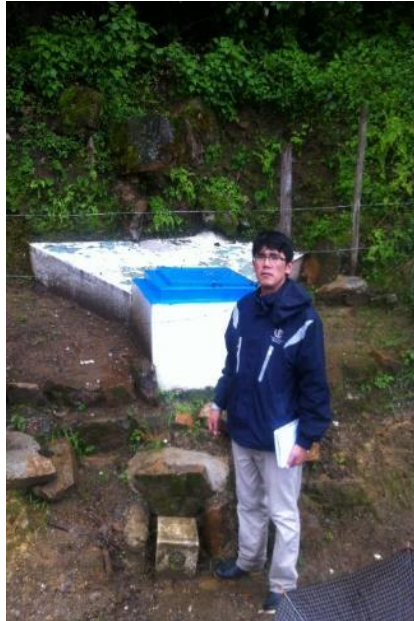
FOTO 11: Captación la Cortadera
