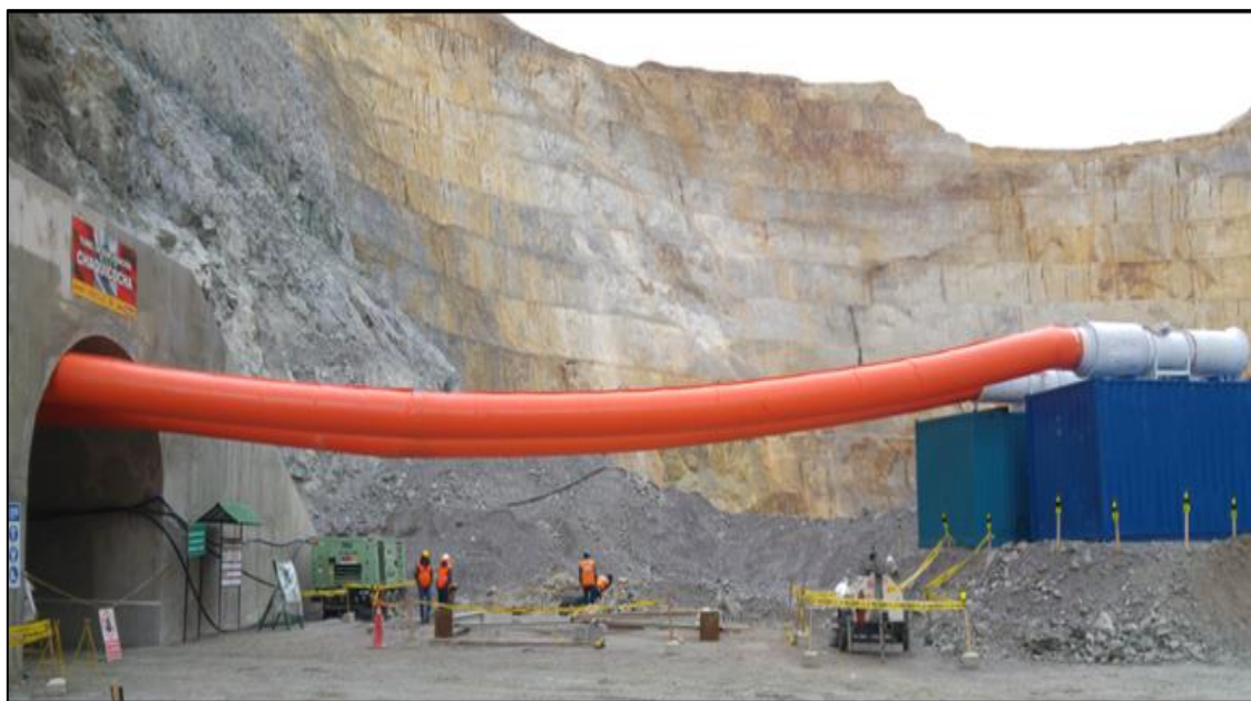
Foto 6. Ventiladores del 30 000 CFM instalados sobre contenedores.
