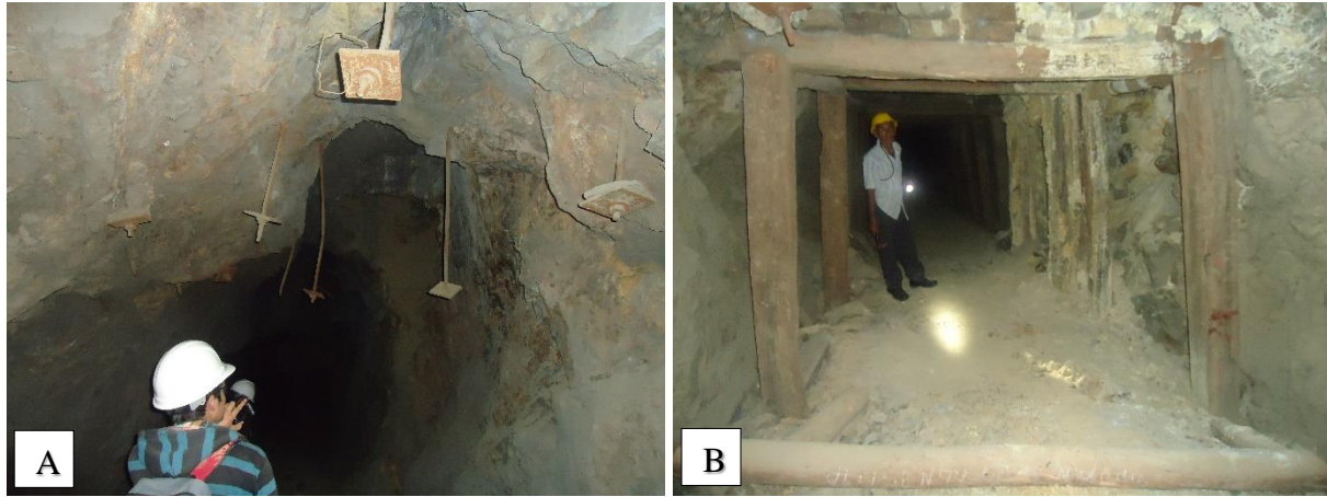
Figura 4.36. A. Pernos de anclaje colocados en el mismo sentido de la Veta Murciélago y no cumpliendo ninguna estabilización. B. Cuadros de madera deteriorados por la fluctuación de agua subterránea.
