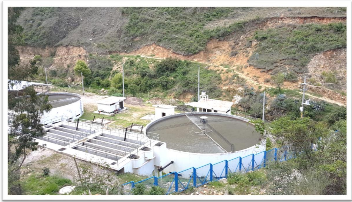
Figura 3 Planta de tratamiento de aguas residuales de Cajabamba
