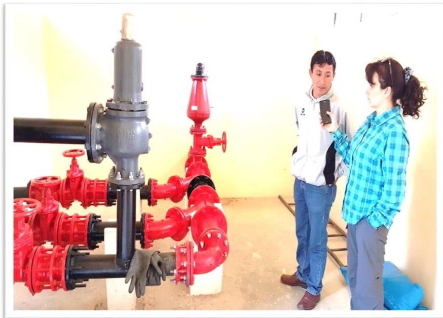
Fotografía N° 6. Estación de bombeo de lodos
