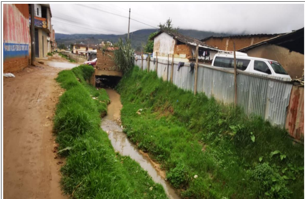
Imagen N° 12: Jr. Pedro Ortiz Montoya, cuadra 4, se muestra el uso de la faja marginal del Río Chico o vía pública para usos privados, taludes del cauce del río erosionados (12/12/2019).
