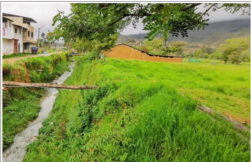
Imagen N° 10: áreas productivas, viviendas y puentes peatonales en la zona denominada Pampa Chica, expuestas al peligro muy alto de inundación. Así mismo se evidencia cruces de tubería de agua sin protección y taludes del río erosionados (12/12/2019).
