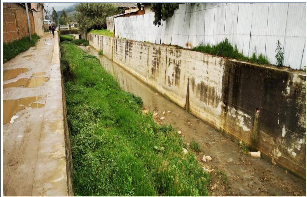
Imagen N° 5: margen derecho del Jr. Pedro Ortiz Montoya cuadra 9, invadido con cercos perimétricos de viviendas, las construcciones son en su mayoría de material precario (03/12/2019).
