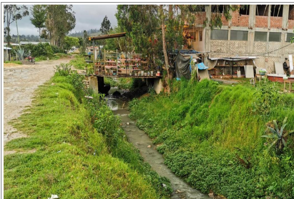
Imagen N° 8: invasión del cauce del Río Chico por vivienda aledaña en la cuadra 14 del Jr. Pedro Ortiz Montoya, construcción de columnas en el mismo cauce del río que incrementa el nivel de riesgo de inundación (08/10/2019).
