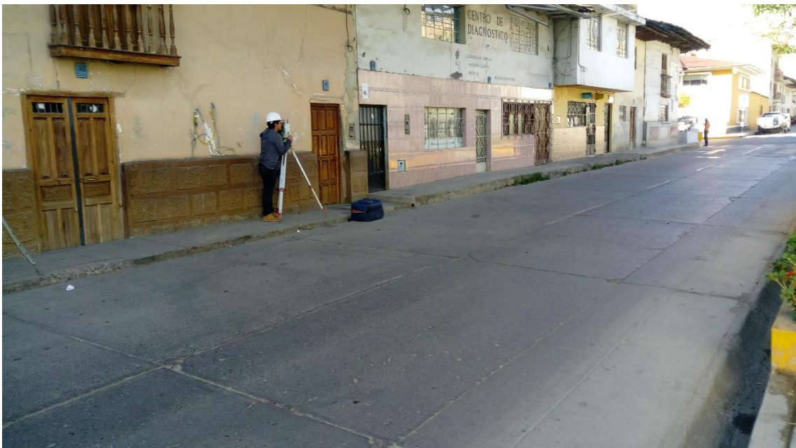
Imagen 04: Levantamiento topográfico en el Jr. Cinco Esquinas, al lado de la institución educativa Santa Teresita.
