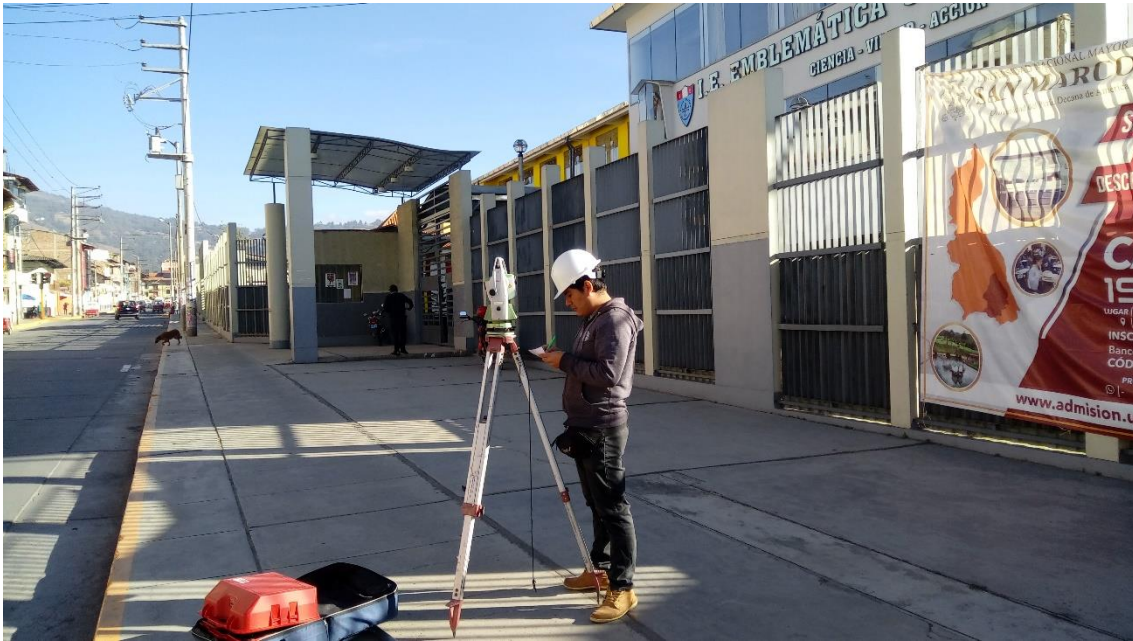
Imagen 05: Levantamiento topográfico en la Av. Mario Urteaga, frente al ingreso principal de la institución educativa Santa Teresita.
