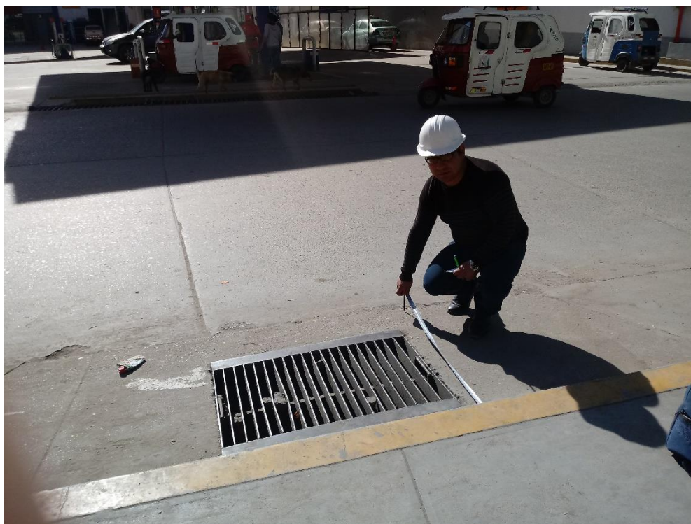
Imagen N° 07: Mediciones de cunetas y veredas Interseccion 02. Av. Vía de Evitamiento Norte – Av. Angamos.
