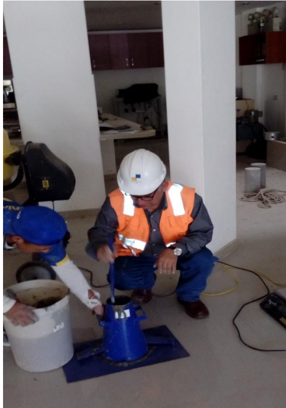
Foto N° 5: Ensayo con el cono de Abrams, para determinar el Slump, consistencia de la mezcla de concreto F'c = 350 \text{ Kg/cm}^2 .
