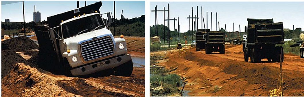
Figura 1. Tramo de terreno natural sin refuerzo y con refuerzo de geomalla utilizando el material in- situ
