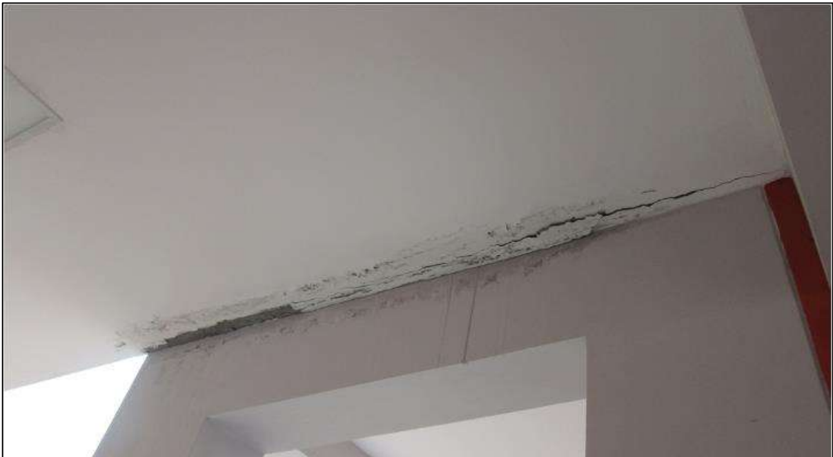
Figura 20: No existe junta sísmica entre el módulo M2 y escalera.
