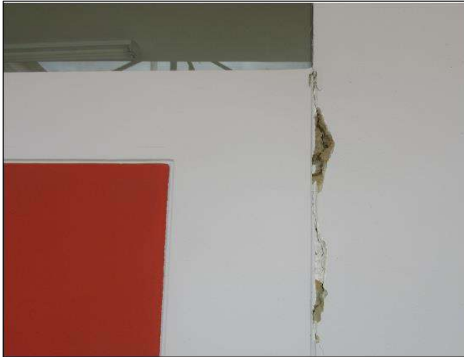
Figura 17: Grietas en unión tabique muro.
