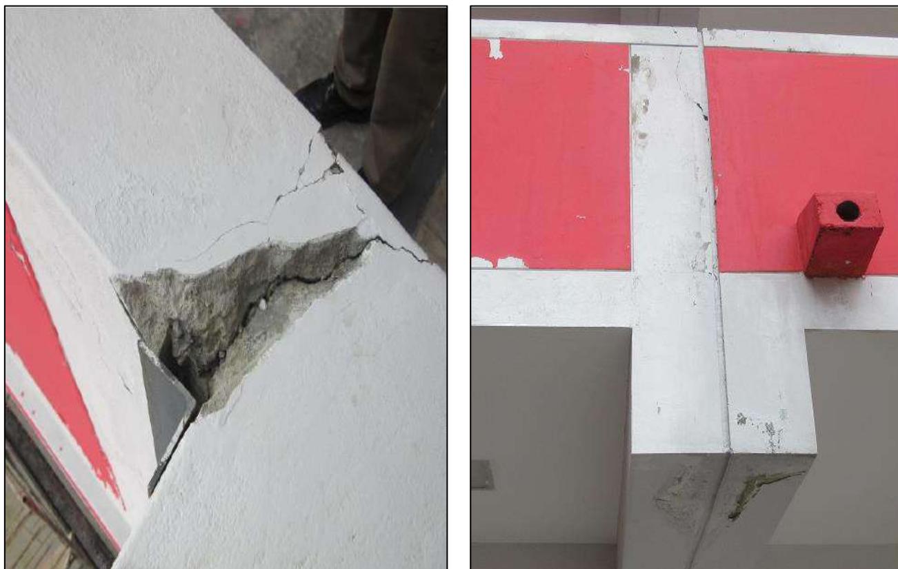
Figura 21: (a)(b) Rajaduras debido a malos procesos constructivos.
