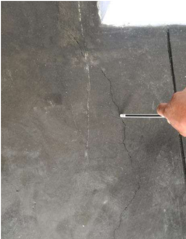
Fotografía 07 y 08: Fisuras y levantamiento de pisos.
