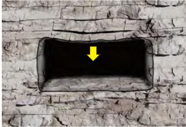
Figura 13. Liberación de los estratos subhorizontales, flexión y caída hacia el vacío del minado. Fuente: SNMPE, 2004.
