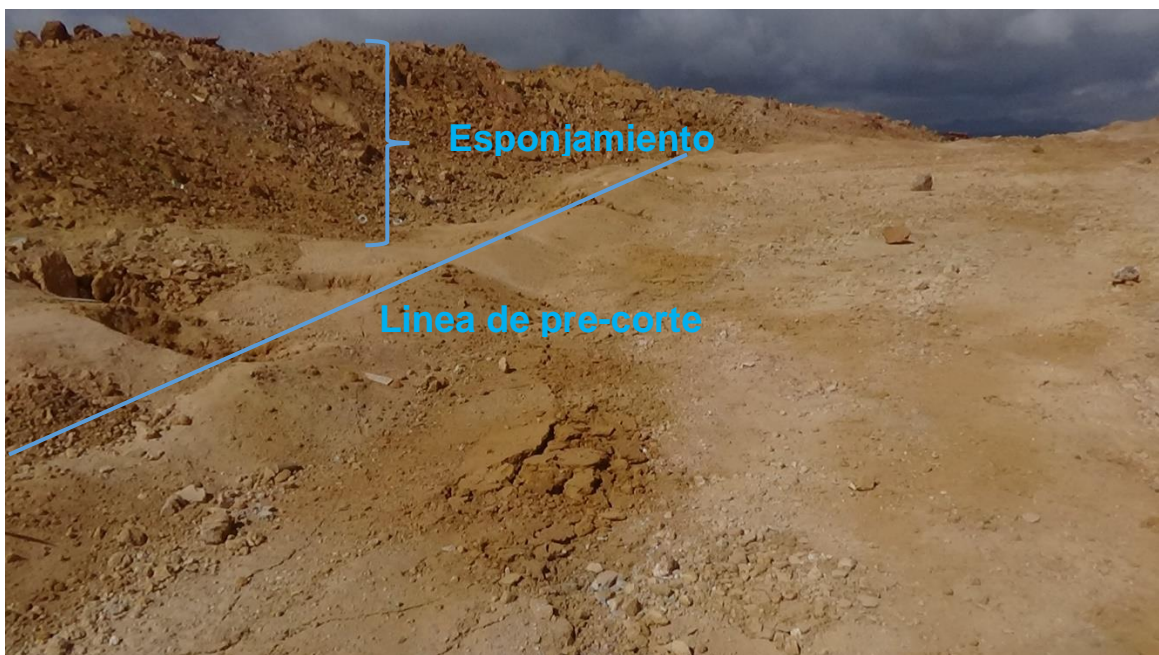
Foto 13. Esponjamiento post voladura. El esponjamiento también es importante para la voladura; los equipos de carguío están diseñados para pilas de material con una altura determinada, en Yanacocha se reporta el esponjamiento del material volado. En la imagen se muestra buen esponjamiento del material.
