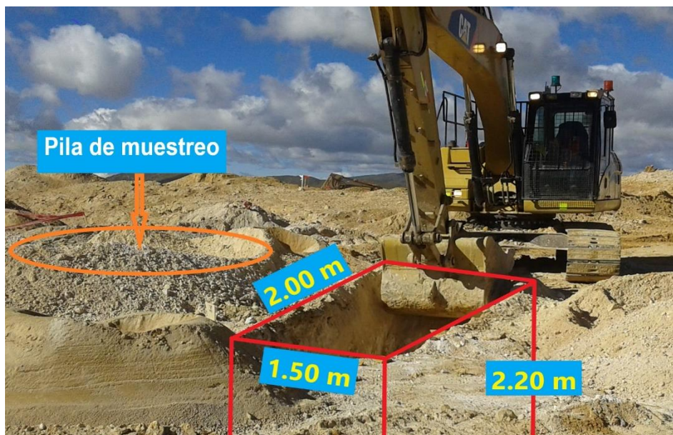
Foto 02. Excavación de la Calicata N° 1 con dimensiones de 2.0 x 1.5 x 2.2 m 3 teniendo un volumen de 6.6 m 3 en el banco de minado de una altura de 10 m, el material extraído es puesto a un costado, la cual sirvió como pila de muestreo para el análisis granulométrico y recojo en las bolsas de muestreo proveído por el Área de Geotecnia - Tajo Quecher Main.
