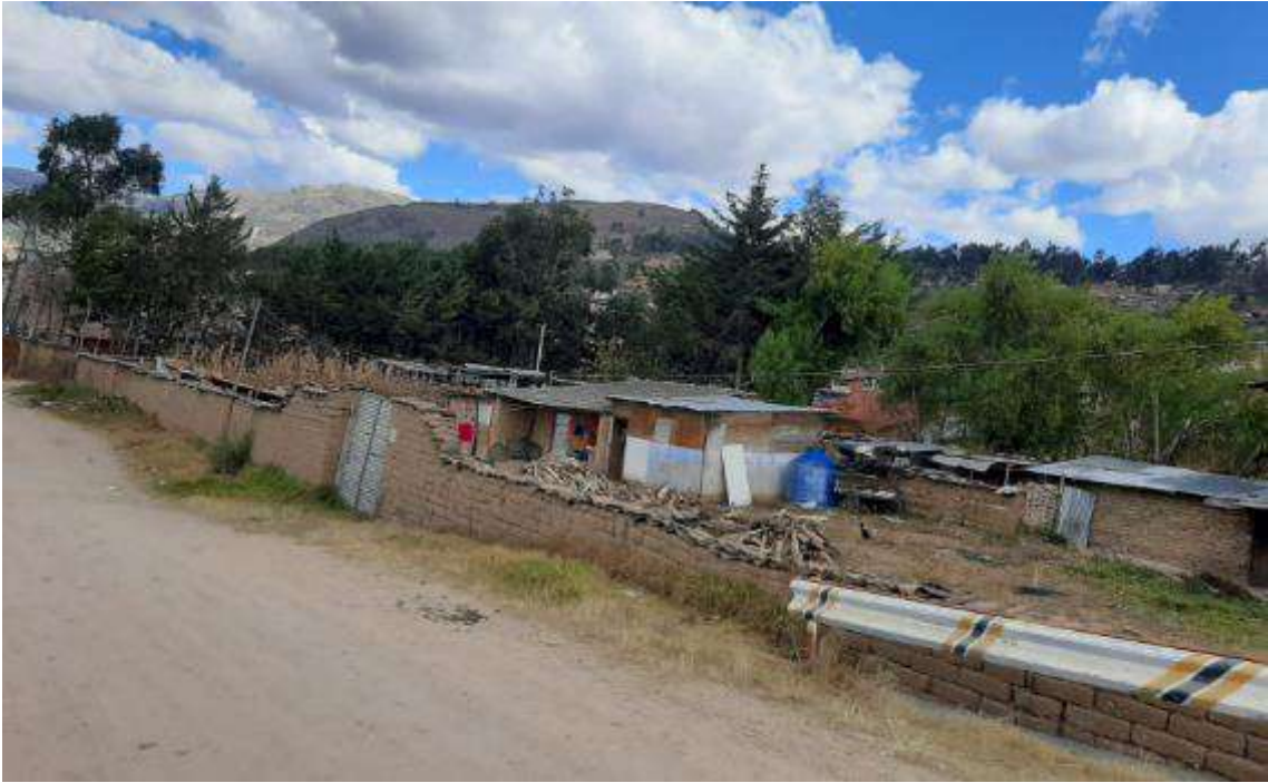
Fig. 38 Vivienda de madera vulnerable ubicada al borde del cauce de la quebrada Cruz Blanca
