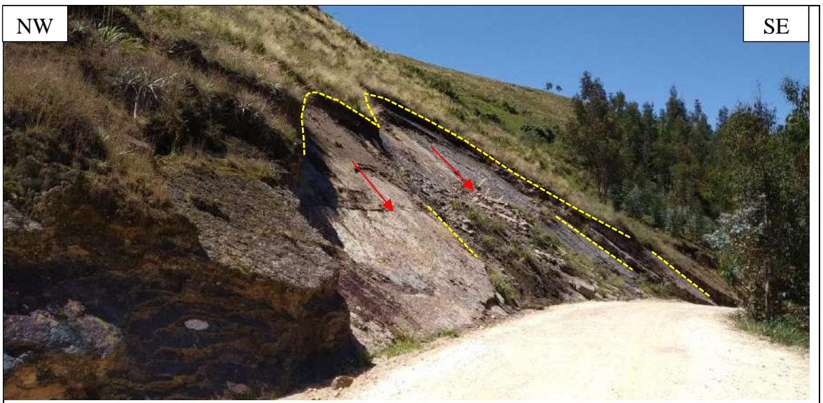
Foto 6: Desprendimiento de bloques de roca por pendiente favorable al buzamiento.
