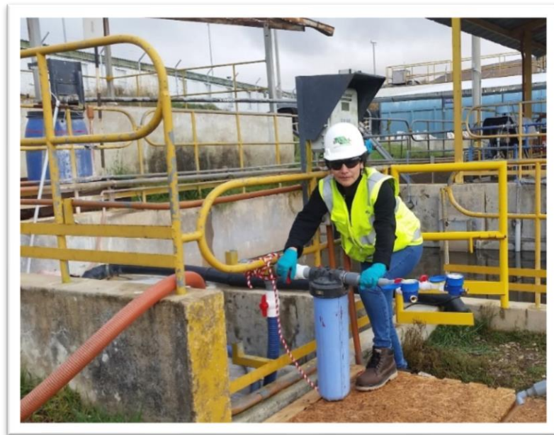
Figura 26. Conexión de filtros con bomba sumergible.
