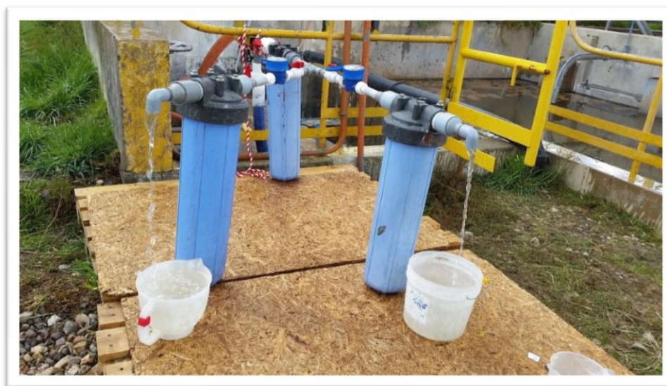
Figura 28. Sistema de tratamiento de decoloración para aguas residuales domésticas.
