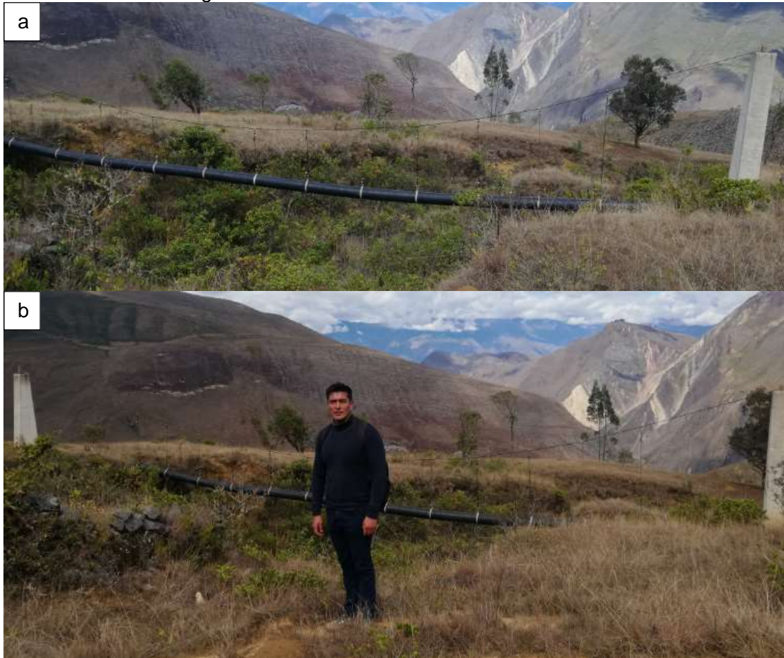
Figura 9: Pases aéreos en línea de conducción
