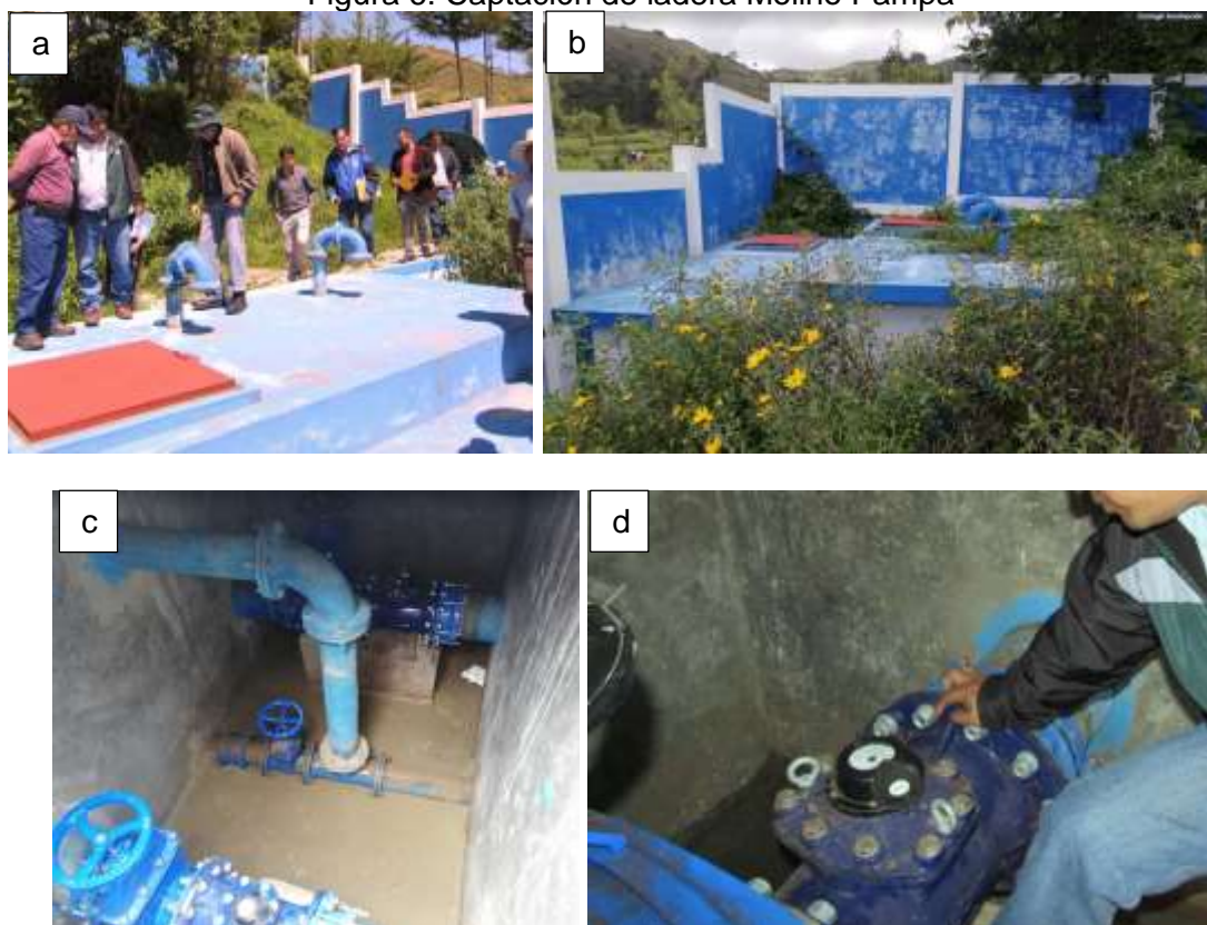
Figura 6: Captación de ladera Molino Pampa
