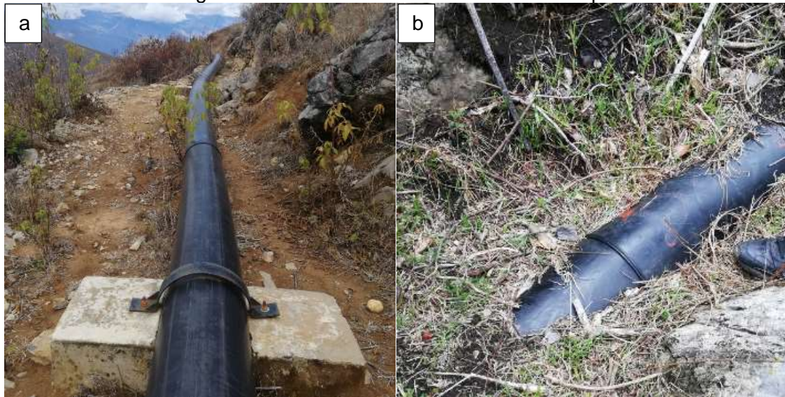
Figura 8: Línea de conducción con tubería hdpe
