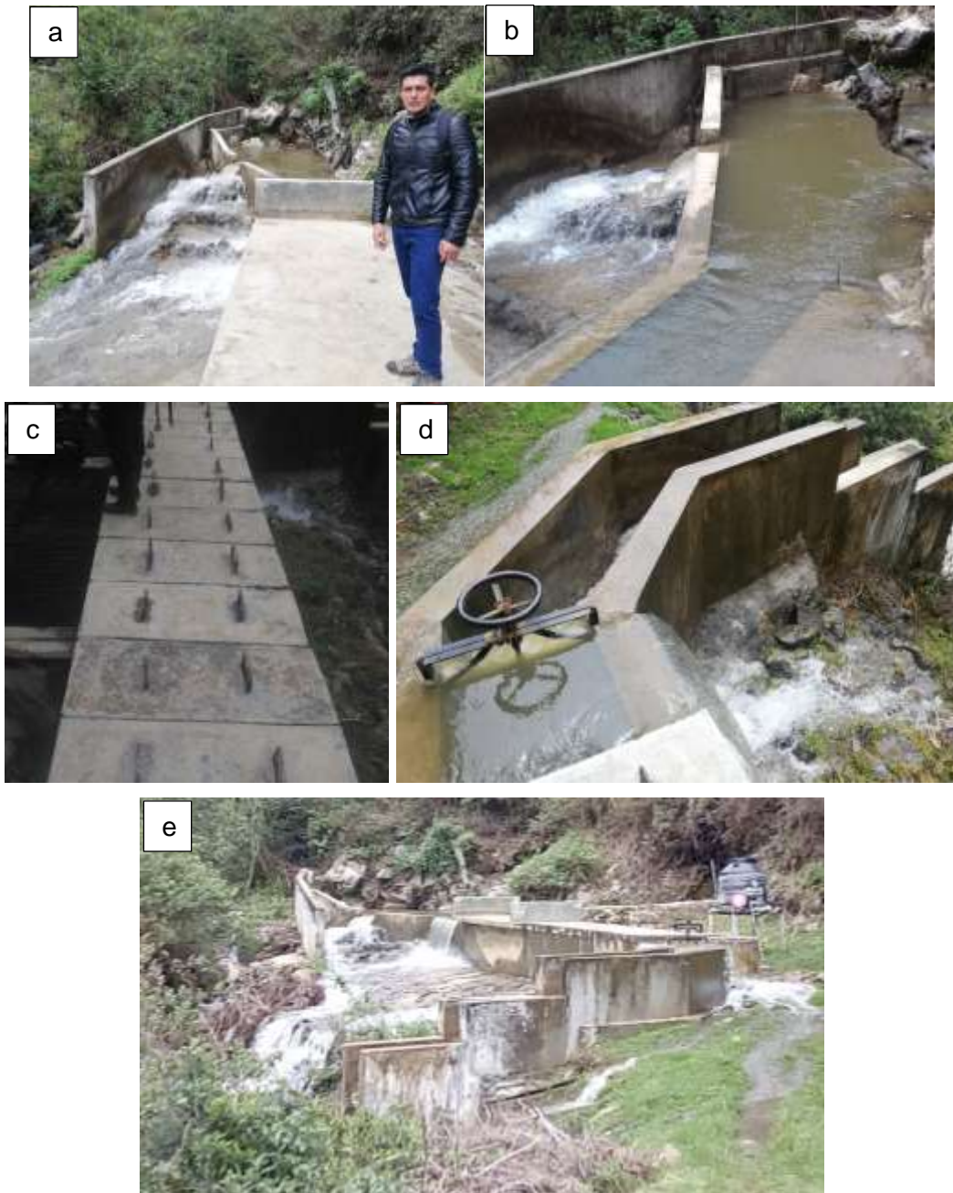
Figura 7: Captación La Quesera
