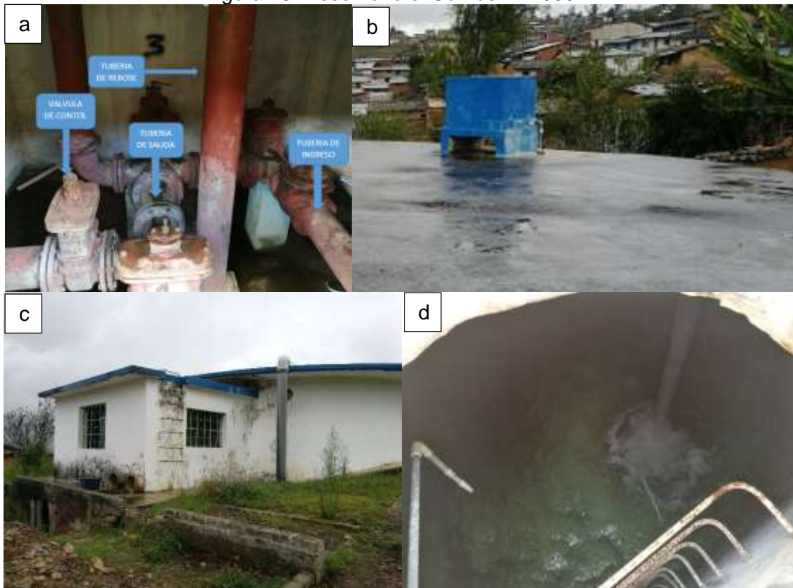
Figura 18: Reservorio el Cumbe V=1000m^3
