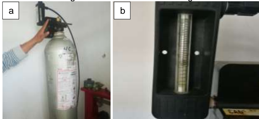
Figura 16: Cloración con cloro gas
