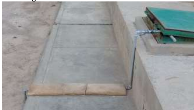
Figura 17: Cámara de contacto de cloro
