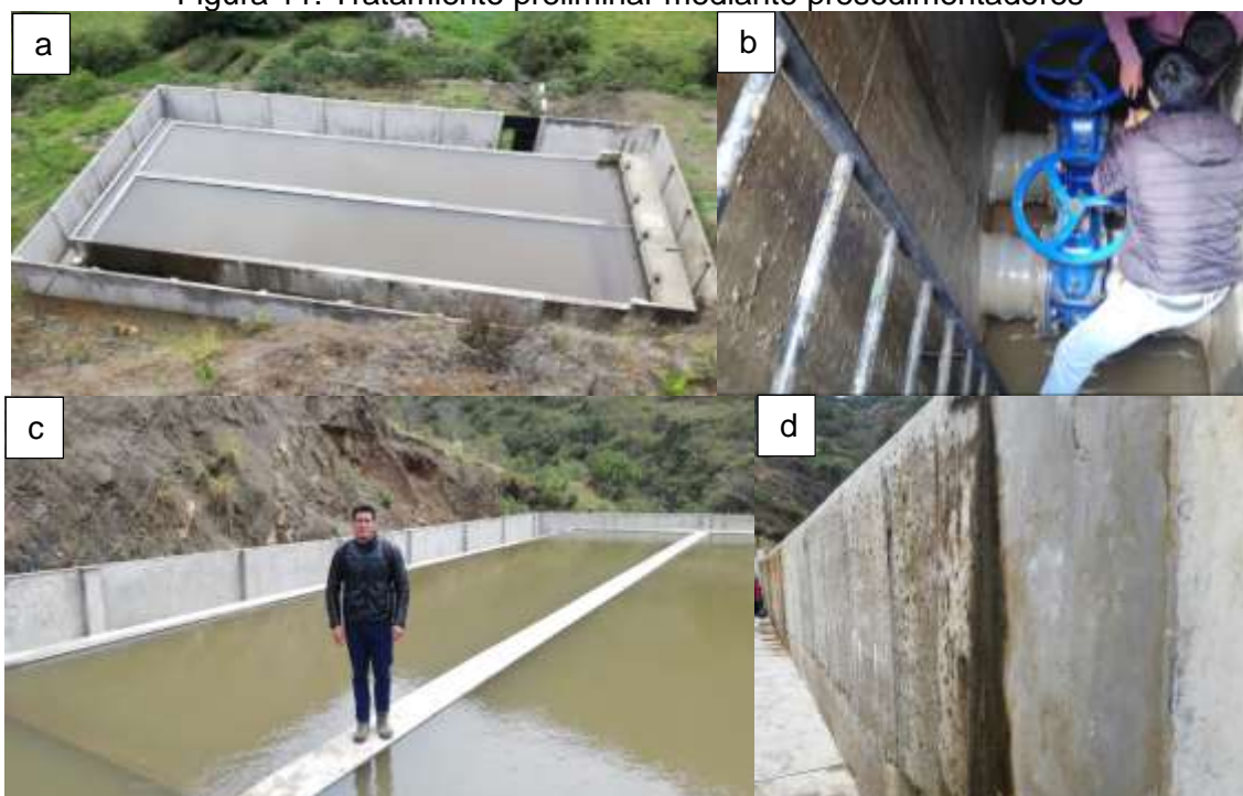
Figura 11: Tratamiento preliminar mediante presedimentadores
