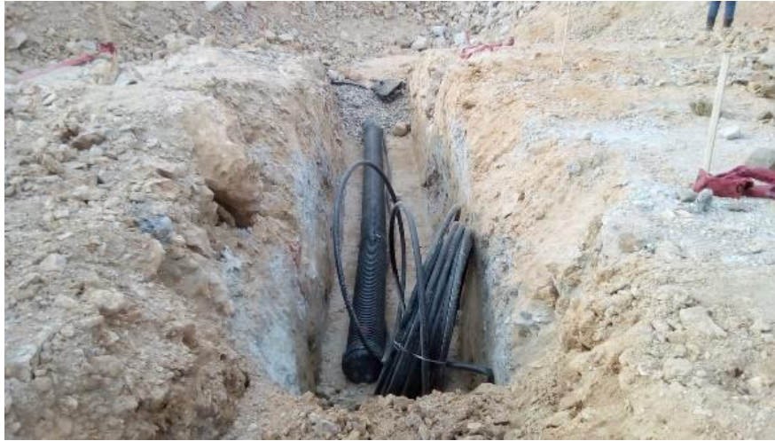
Foto 3. Ramal principal del sistema de subdrenaje en el PAD de lixiviación Ciénaga Norte
