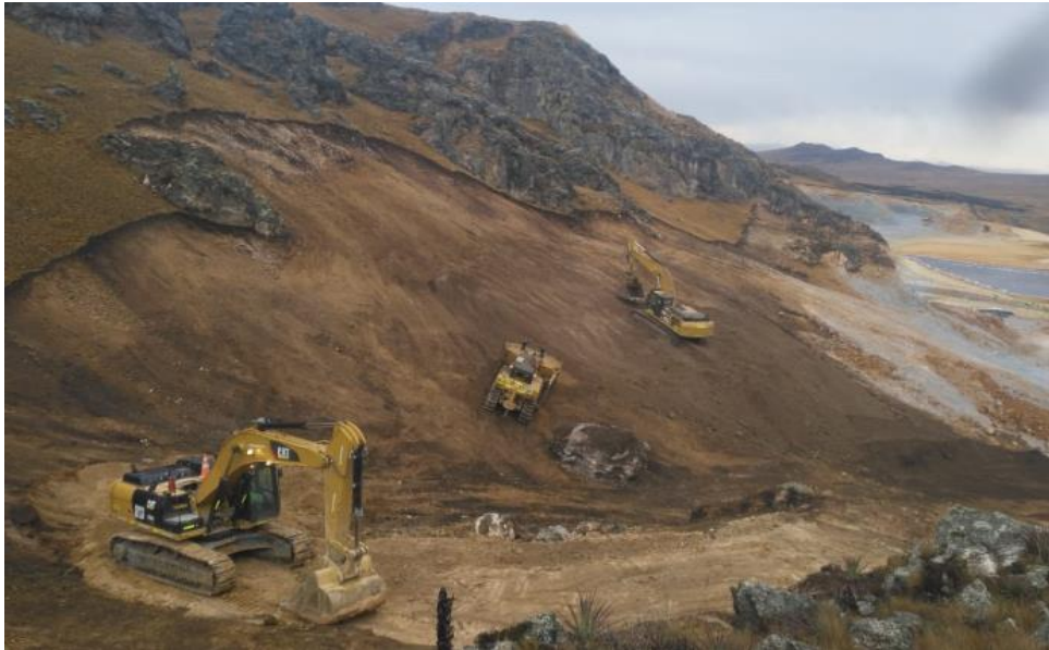
Foto 1. Excavadoras realizando desbroce de material orgánico en zona de corte del PAD Ciénaga Norte
