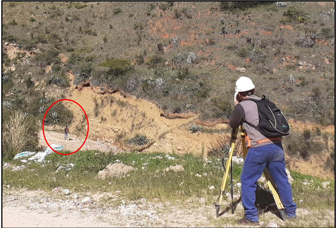
Foto A.17. Visando el último punto antes del cambio de Estación, en el levantamiento topográfico de la carretera Catan – Yuracmarca.
