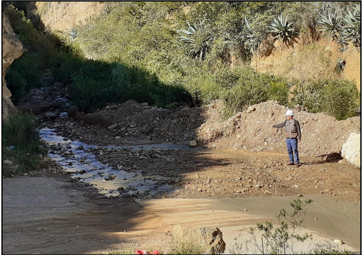
Foto A.15. Falta de alcantarillado en la curva n°12, esto es común en todas las curvas.
