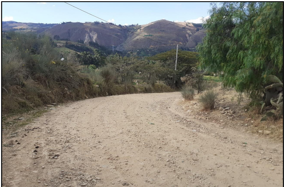
Foto A.20. Apreciación de falta de cunetas (curva n°1). Hay tramos considerables sin cunetas.
