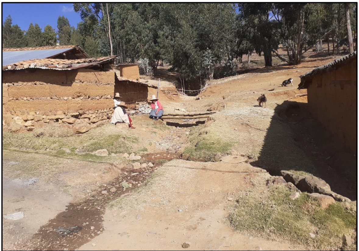
Foto A.16. Se aprecia la falta de alcantarillado en un tramo tangencial de la carretera, se repite en varios tramos.
