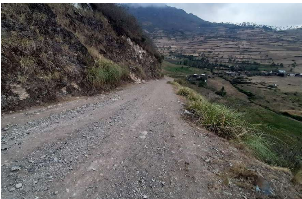
Fotografía N°16: Zona de ancho de vía menor al mínimo requerido.
