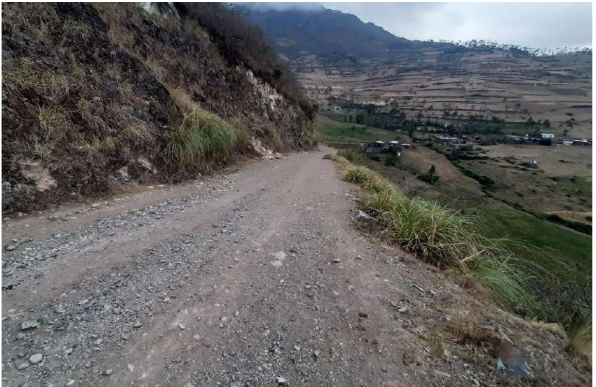
Fotografía N°16: Zona de ancho de vía menor al mínimo requerido.
