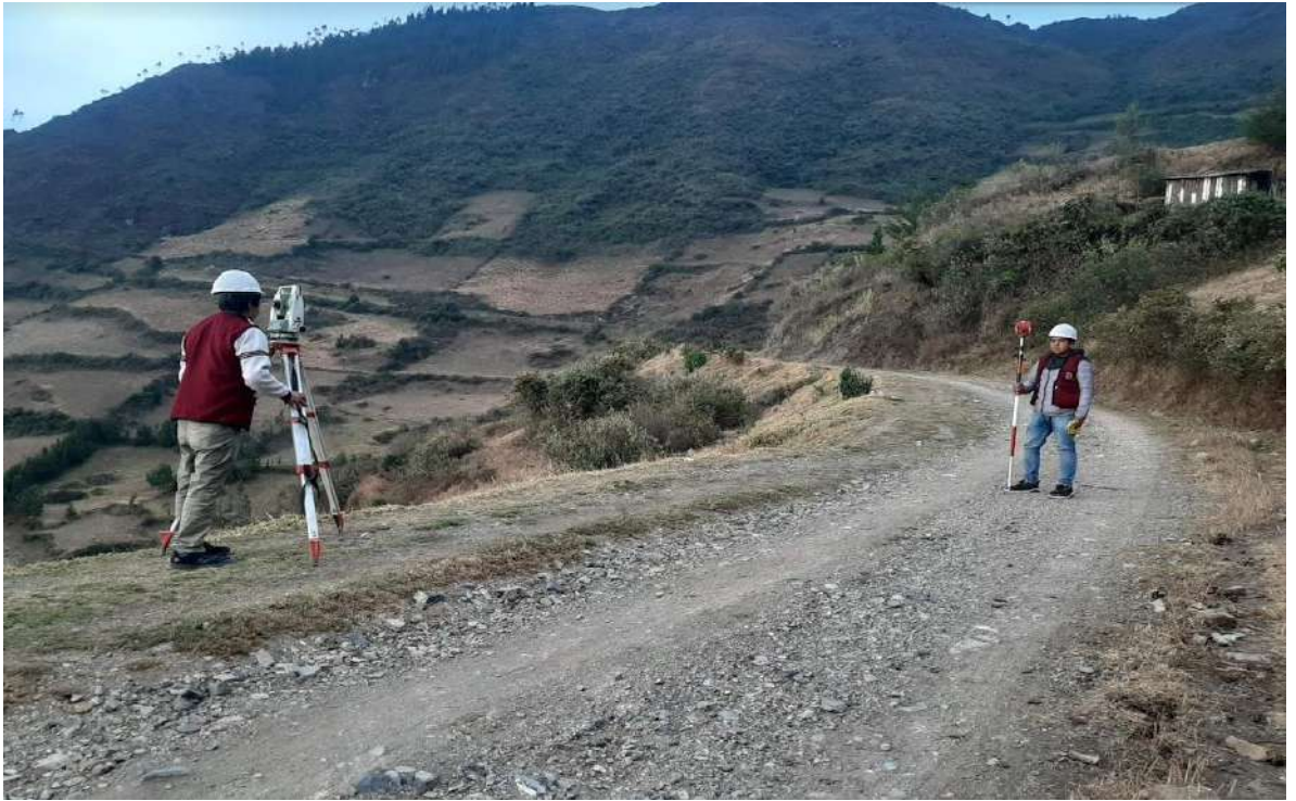
Fotografía N°09: Toma de puntos en eje y cálculo de pendiente con estación total.
