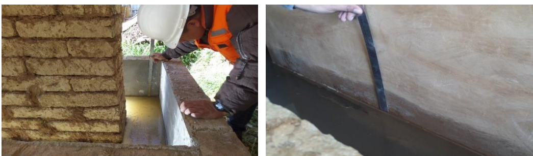
Figura 24: Medida Absorción en pozo impermeabilizado y succión en muros
