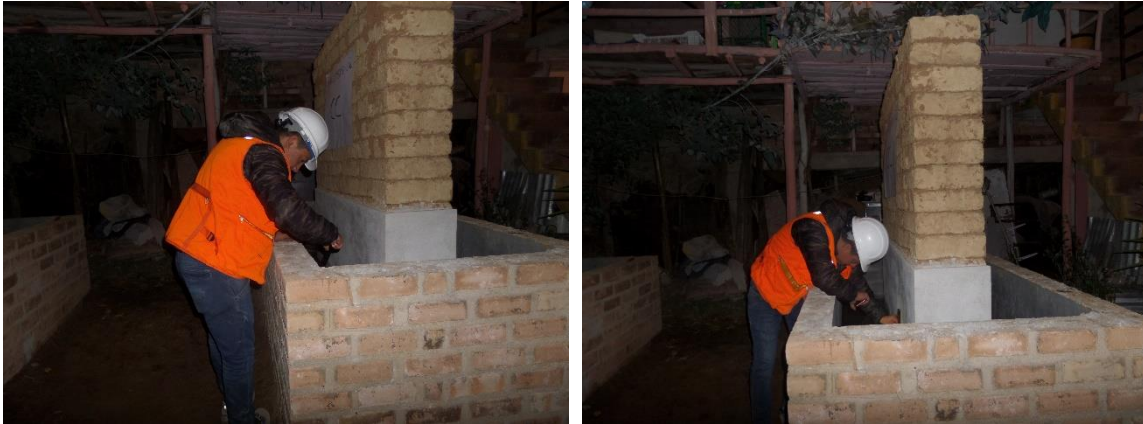
Figura 75: Medidas final segundo periodo - Muro Cemento – Cal
