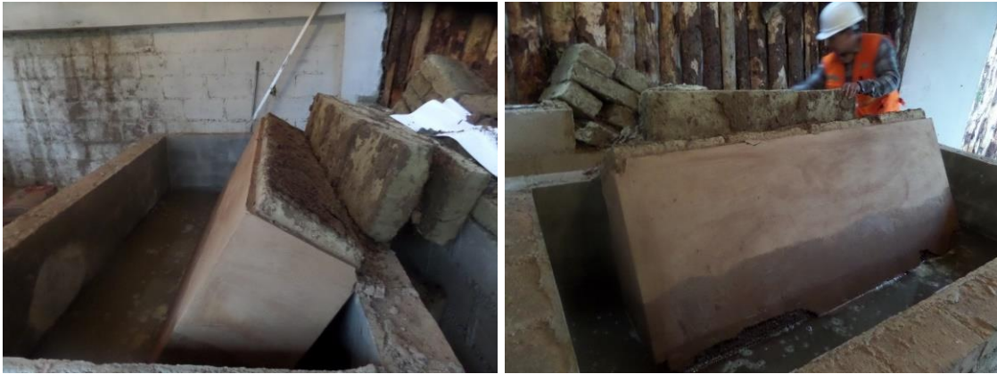
Figura 73: Colapso Muro Tierra Roja – Cal
