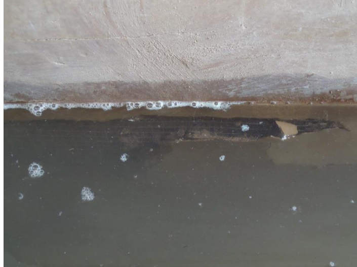
Figura 66: Perdida del Recubrimiento Tierra Roja – Cal
