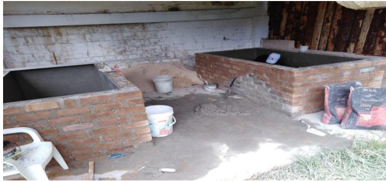
Figura 127: Pozos Impermeabilizados CY -TRC
