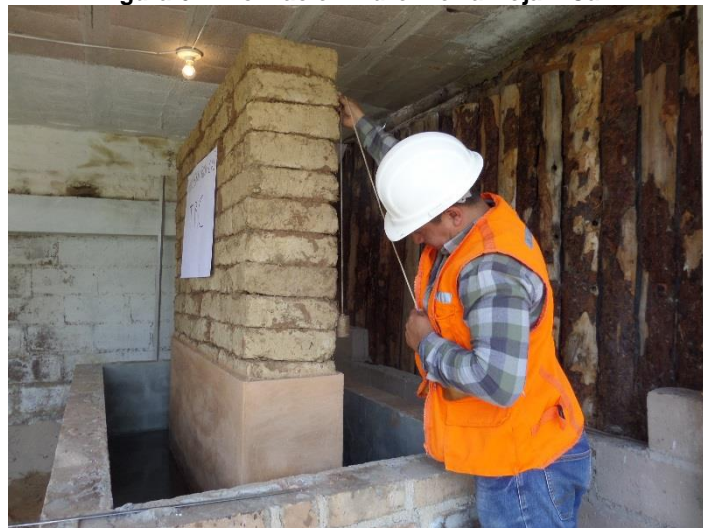
Figura 67: Inclinación Muro Tierra Roja – Cal
