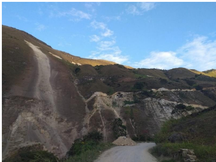
Figura 19. Pendiente con presencia de erosión (Centro poblado de San Antonio).
