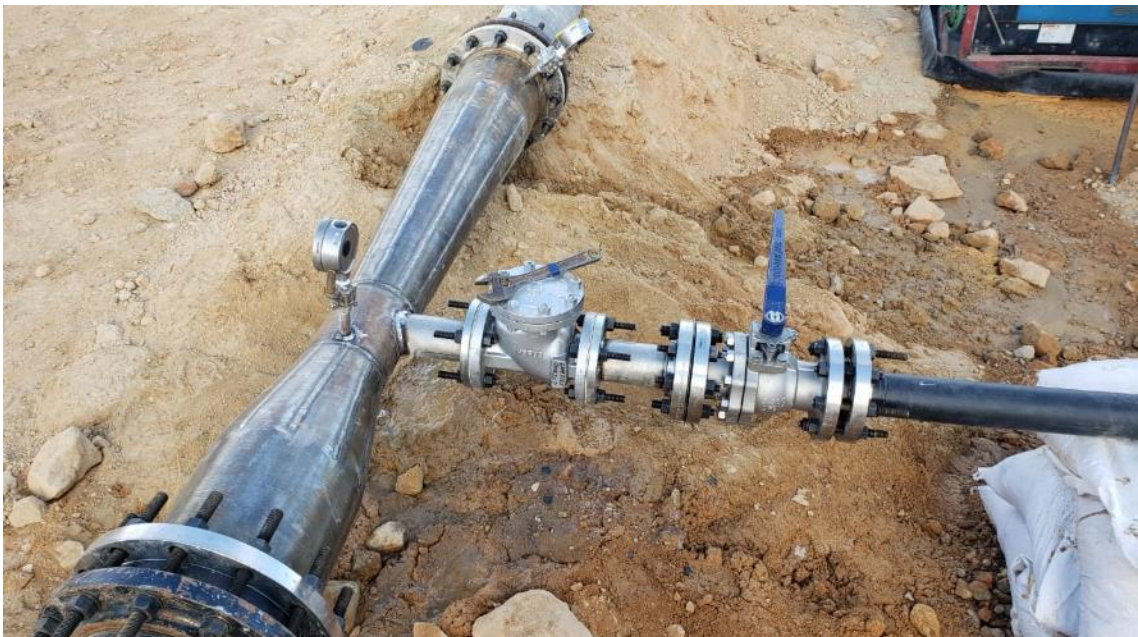
Figura 80: Venturi de chapa instalado con el ingreso de tubería de supresor de polvo
