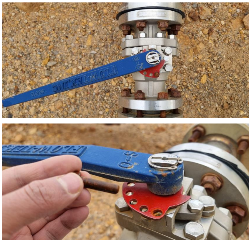
Figura 88: Ángulo de apertura de válvula tipo globo, calibrado para dosificación
