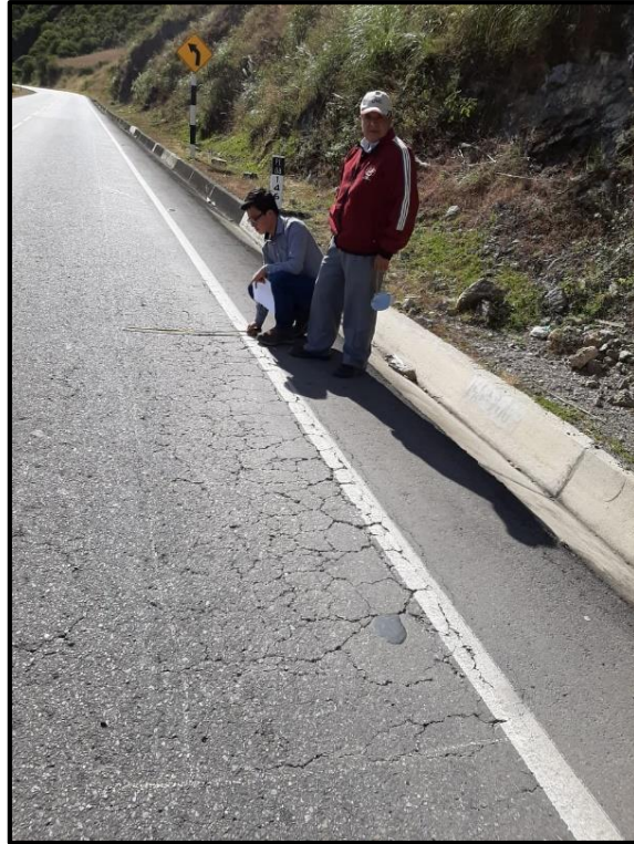
Imagen 9. Asesor en el proceso de inspección de fallas
