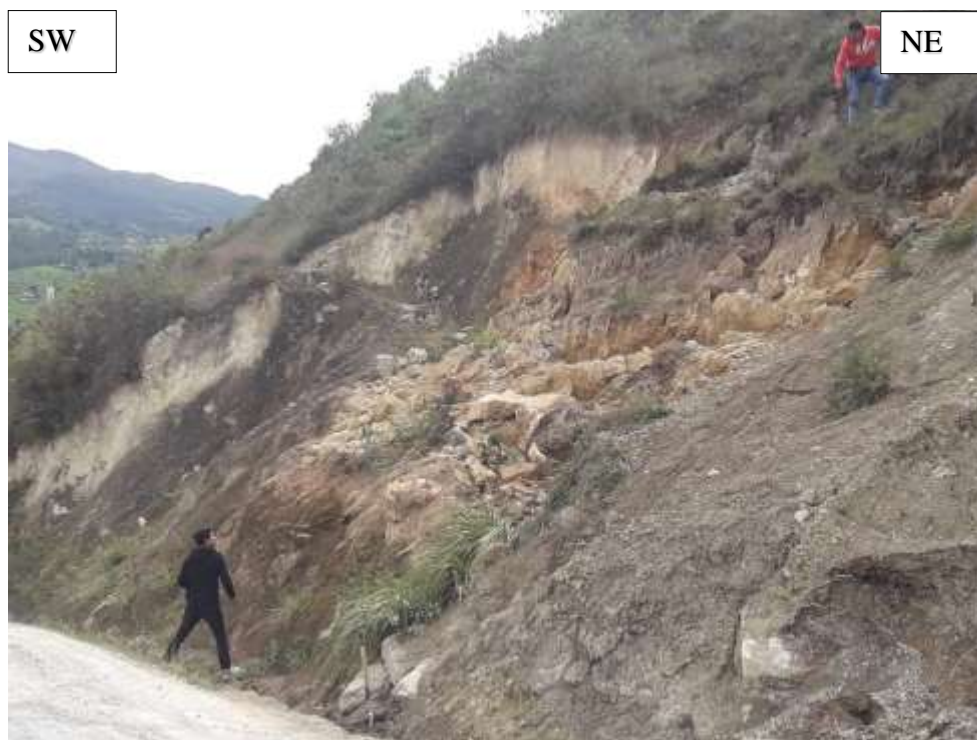
Foto 3.15. Rotura circular de pie, afectando 40 m. de la carretera entre la progresiva: Km. 06+100-Km. 06+140. Coordenadas E: 780420 N: 9265444, cota: 2748 m.s.n.m.
