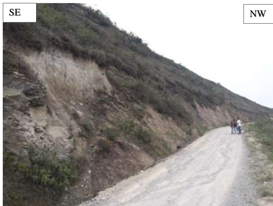
Foto 3.16. Rotura circular de pie, afectando 30 m. ubicado en el flanco izquierdo de la carretera entre la progresiva: Km. 05+955-Km. 05+985. Coordenadas E: 780436, N: 9265446, cota: 2751 m.s.n.m.
