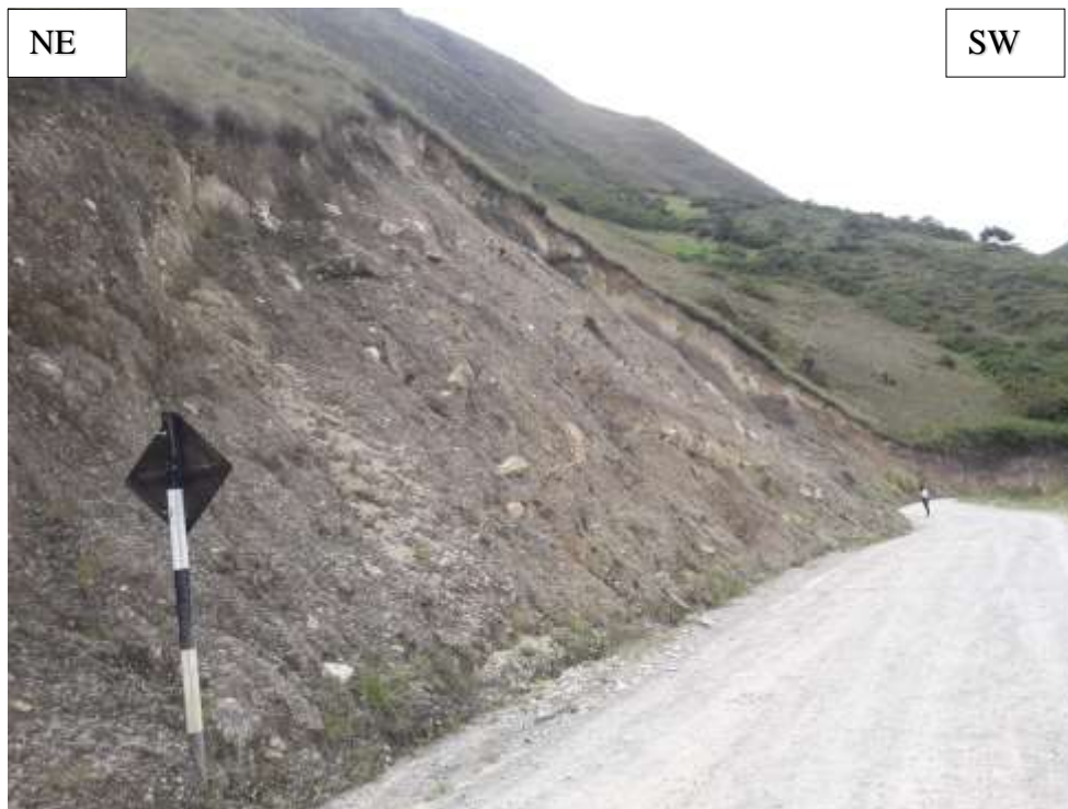
Foto 3.18. Cárcavas en el talud del flanco derecho de la carretera entre la progresiva: Km. 01+700-Km. 01+750. Coordenadas E: 778262 N: 9265827, cota: 2477 m.s.n.m.
