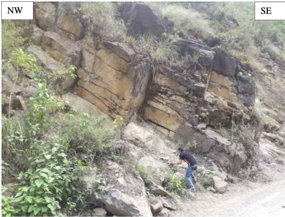
Foto 3.19. Inestabilidad en el talud del flanco derecho de la carretera entre la progresiva: Km. 00+200-Km. 00+300. Coordenadas E: 777146 N: 9265444, cota: 2515 m.s.n.m.
