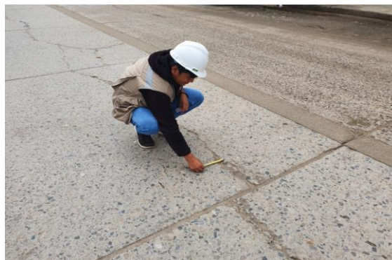
Figura 54. Falla de grieta lineal de alta severidad ubicada en la um-14
