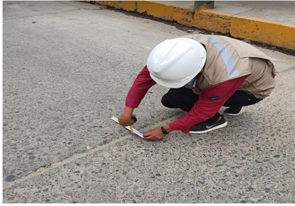
Figura 51. Falla de escala ubicada en la um-03.
