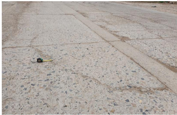
Figura 55. Falla de grieta de esquina de severidad media ubicada en la um-19
