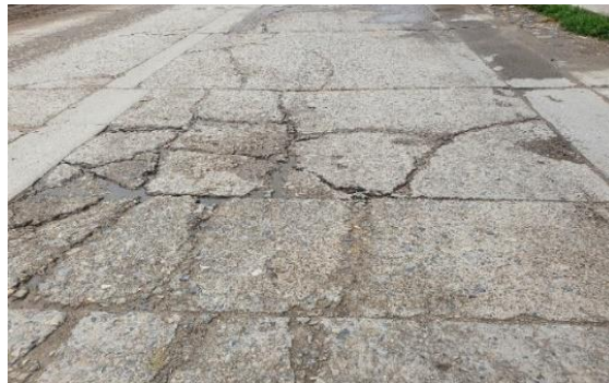
Figura 53. Falla de punzonamiento de alta severidad en la um-11
