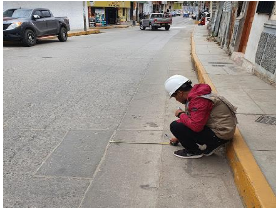
Figura 52. Falla de parche grande encontrada en la um-03.
