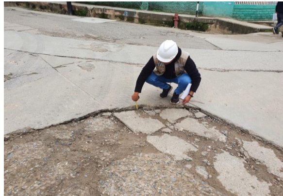
Figura 56. Descaramiento de esquina de severidad leve ubicada en la um-27
