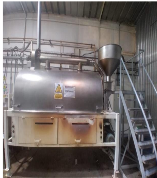
Figura 29. Tostador tipo batch
