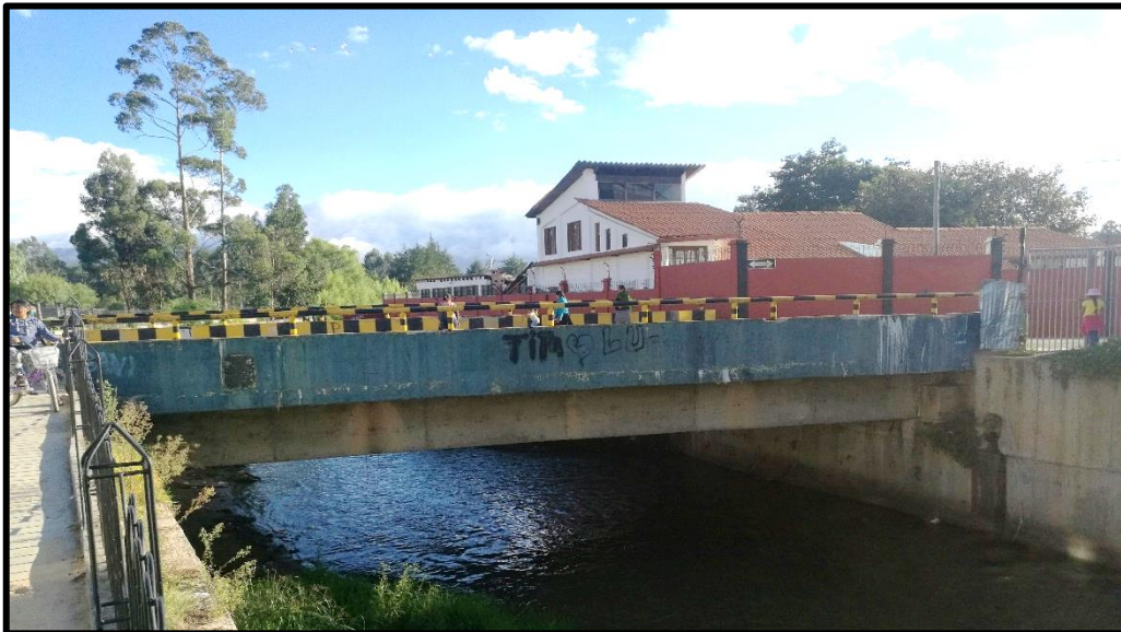
Foto N° 8 : Vista de vigas principales del puente alternativo de acceso al distrito Baños del Inca
