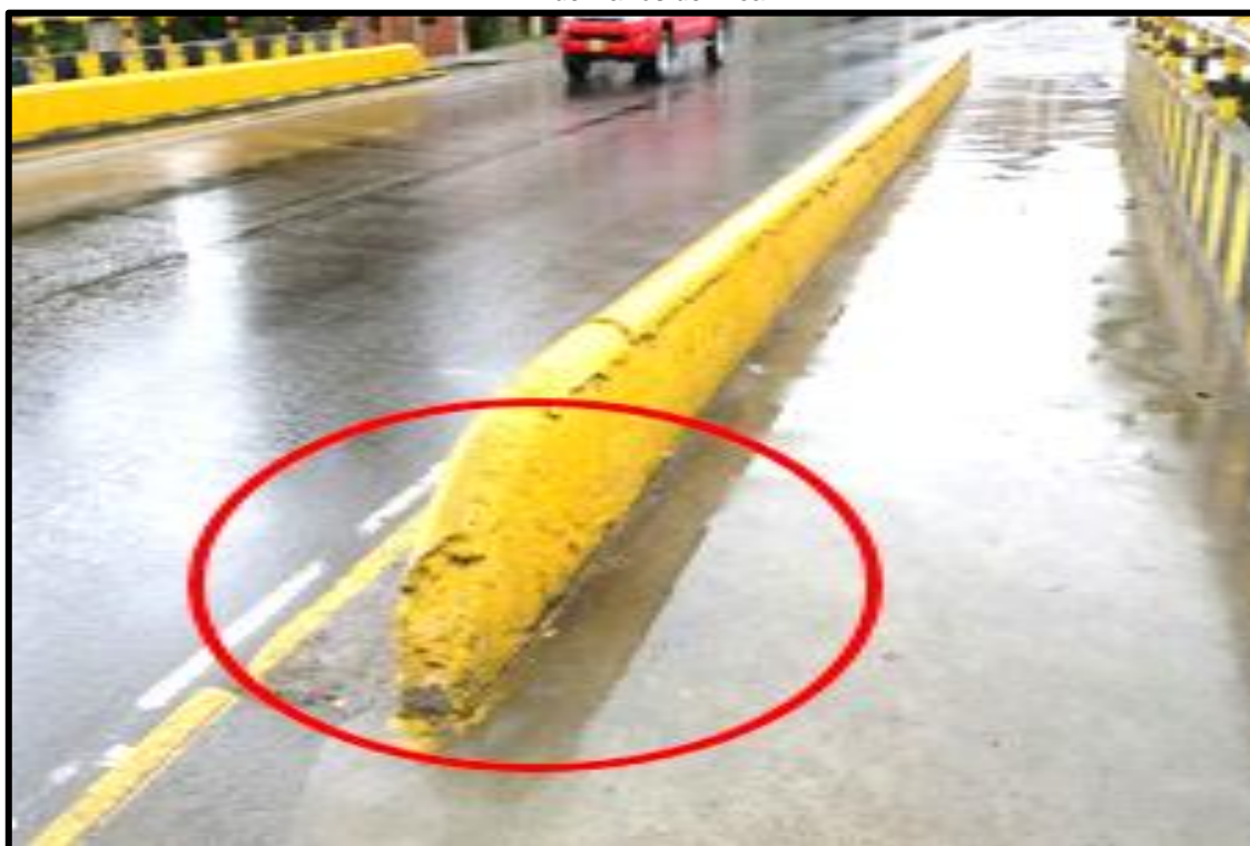
Foto N° 1: Sardinel deteriorado, del puente de acceso principal al distrito de Baños del Inca
