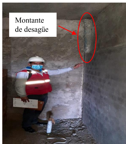
Montante de desagüe expuesta en muro portante
