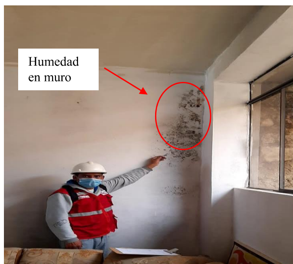
Humedad en muro portante
