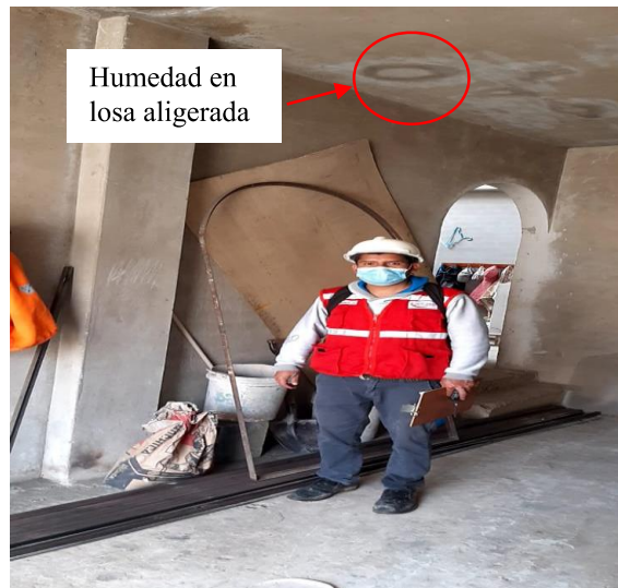
Humedad en losa aligerada
