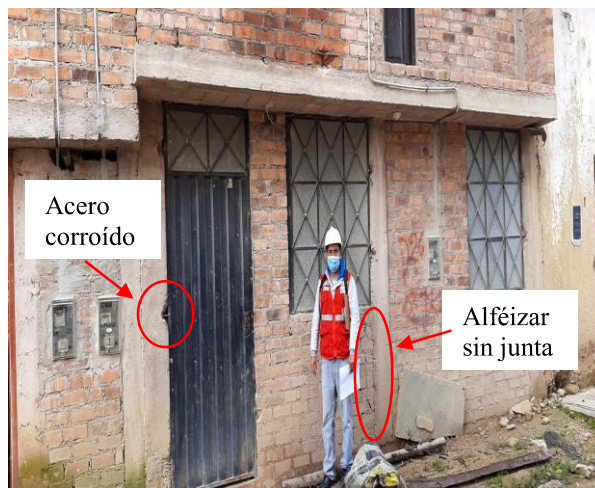
Acero expuesto en ingreso a la vivienda.
