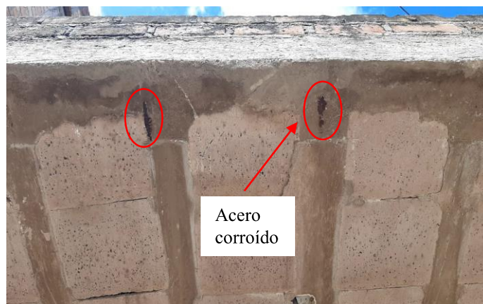
Falta de un adecuado recubrimiento en losa aligerada, corrosión del acero.
