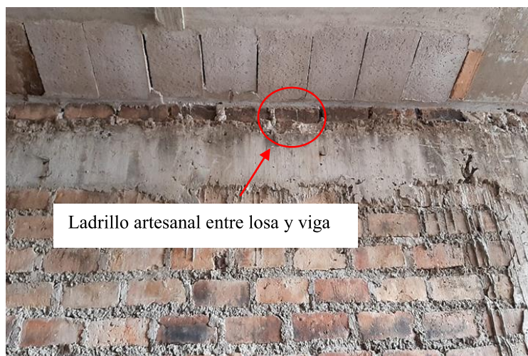
Junta fría, para llegar a la altura se colocó ladrillos sobre la viga que debió ser vaciado con la losa aligerada.
