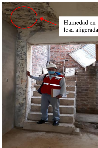
Humedad en losa aligerada y columna
