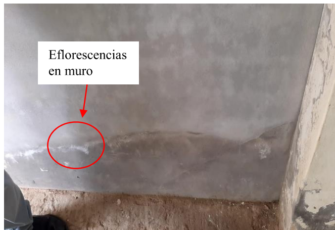
Eflorescencias en muros portantes de la vivienda
