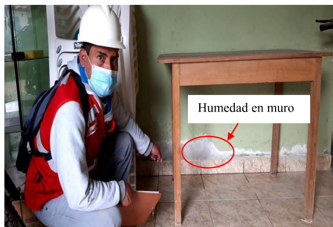
Humedad en muros de la vivienda.
