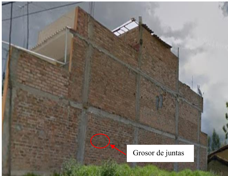
Grosor de junta mayor de 15 mm, tabiquería sin columnetas y alfeizar sin juntas
