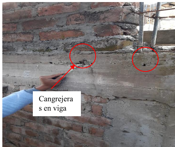
Acero expuesto en viga chata y cangrejeras
