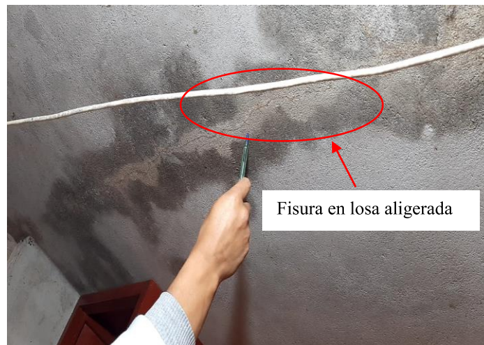
Fisura longitudinal en losa aligera, así también se puede apreciar la humedad en esta.
