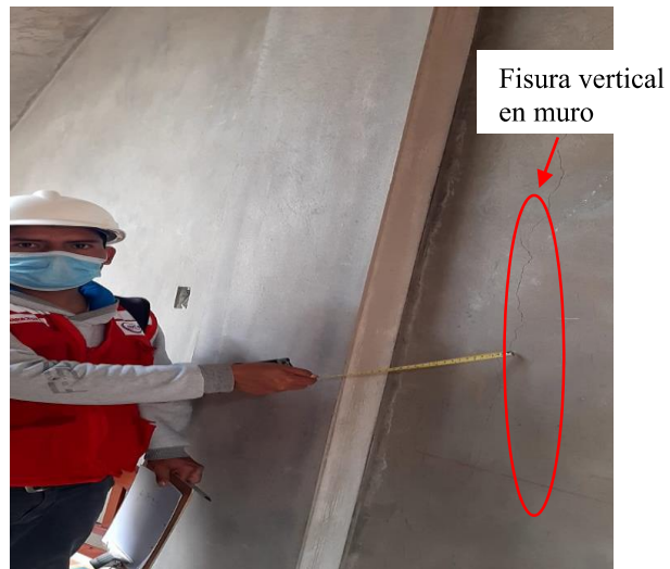
Fisura vertical en muro portante
