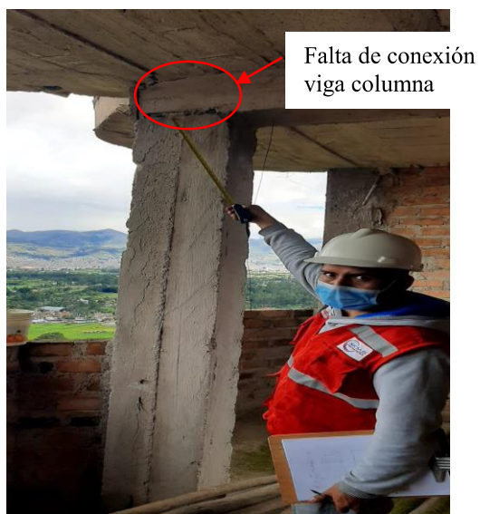
Deficiencias en la conexión viga columna
