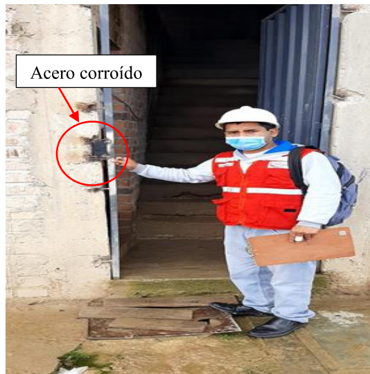
Acero expuesto y corroído en el ingreso a la vivienda
