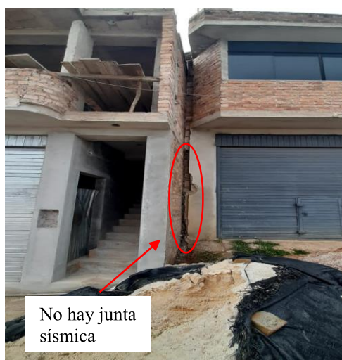
Falta de junta sísmica entre viviendas
