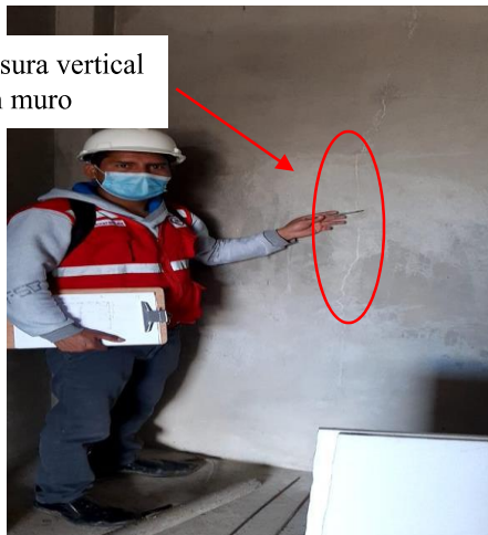
Fisura vertical en muro portante
