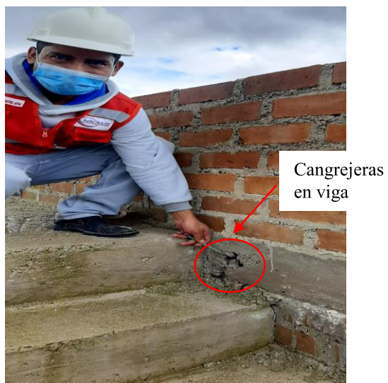
Cangrejas en viga chata de la vivienda
