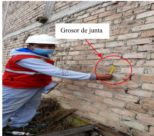
Grosor de junta mayor de 15mm en la vivienda
