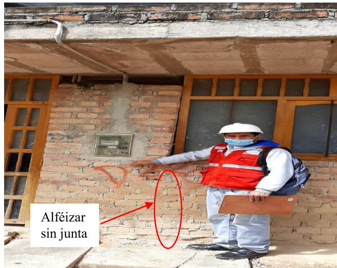
Tabiquería sin columnetas, alféizar sin junta
