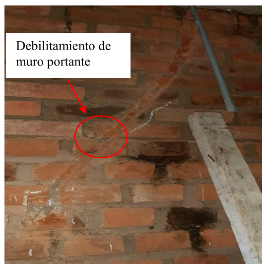
Cortes en diagonal en muros portantes
