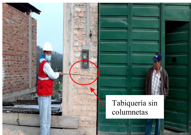
Tabiquería sin columnetas, grosor de las juntas mayores a 15mm
