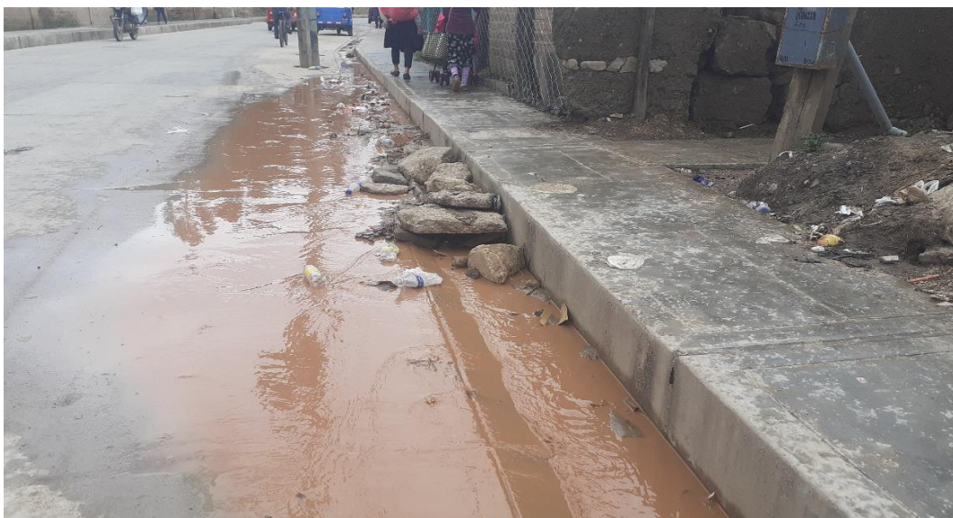
Figura 9: Acumulación de sedimentos en la cuneta de la Av. Moyococha.
