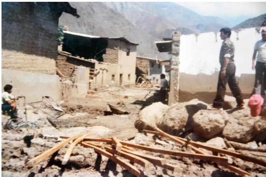
figura N.º70: verificación de pérdidas materiales. Edificaciones de adobe.
