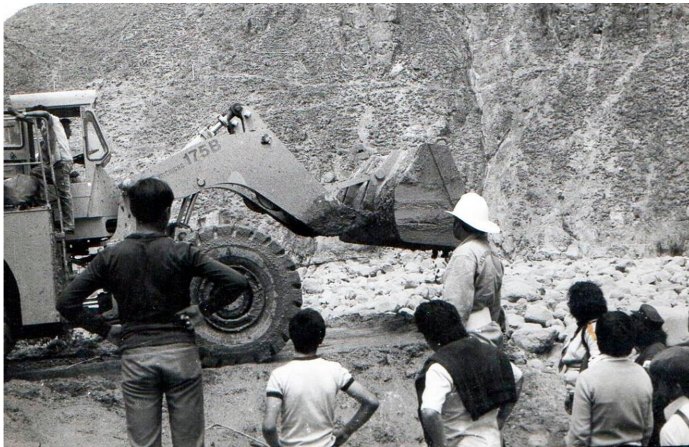
Figura N.º 66 : Limpieza del Cauce de la Quebrada Huertas luego de la Inundación.
