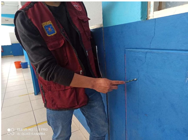
FIGURA 3: PRESENCIA DE FISURAS EN TABIQUES AISLADOS DE ALBAÑILERÍA
