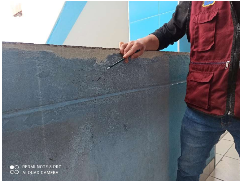
FIGURA 5: PRESENCIA DE FISURAS EN PARAPETOS DEL CORREDOR
