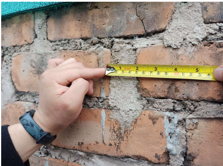
FIGURA 18: ESPESOR DE MORTERO ENTRE UNIDADES DE ALBAÑILERÍA, MAYOR A LO PERMITIDO
