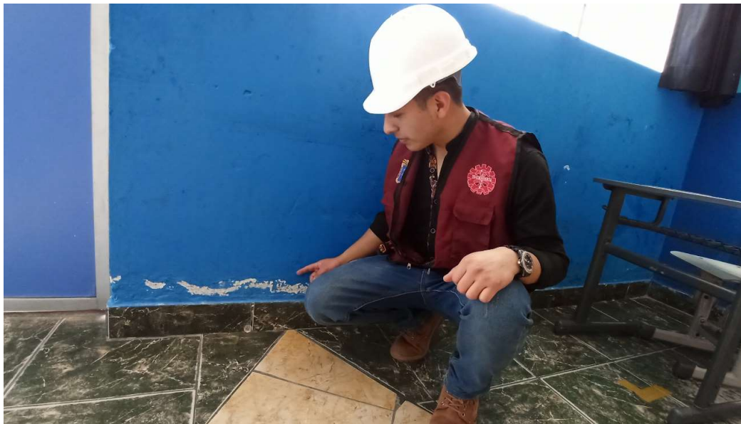
FIGURA 5: PRESENCIA DE HUMEDAD TABIQUES EN EL 1º NIVEL DEL PABELLÓN ESCOLAR B
