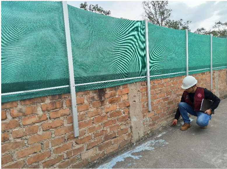
FIGURA 17: INSPECCIÓN EN AZOTEA DEL PABELLÓN "B", LA LOSA PRESENTA UN CONTRAPISO
