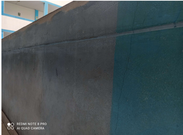
FIGURA 21: PRESENCIA DE FISURAS EN TABIQUES DEL PABELLÓN ESCOLAR "B"
