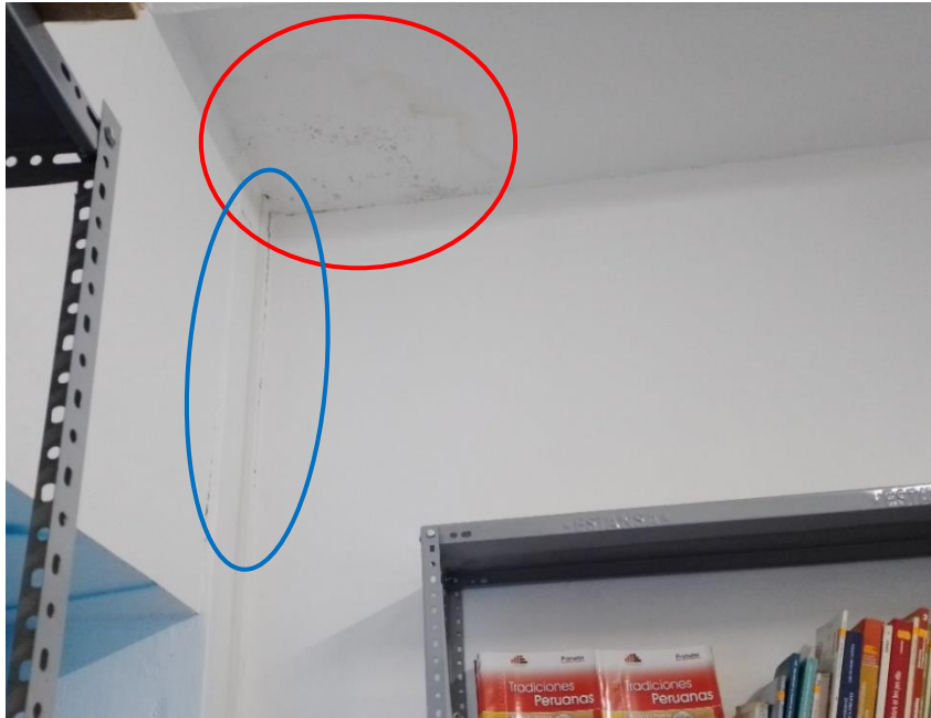
FIGURA 30. Presencia de humedad en cielo raso y grieta en unión de muros de tapial de la I.E.P. “Nuestra Señora de Fátima”.
