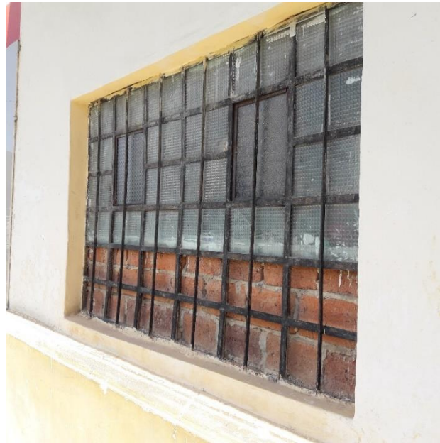
FIGURA 28. Incompatibilidad de materiales en muros de tapial de la I.E.P. “San Isidro”.
