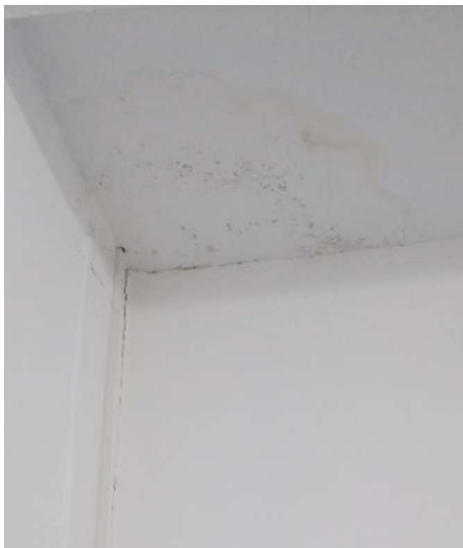
FIGURA 31. DETALLE de presencia de humedad en techo y grieta en unión de muros de tapial de la I.E.P. “Nuestra Señora de Fátima”.
