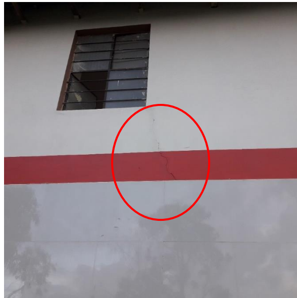
FIGURA 26. Grietas a lo largo de la fachada de la I.E.P. “San Isidro”.
