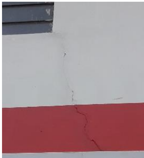
FIGURA 27. DETALLE de grieta en fachada de la I.E.P. “San Isidro”.
