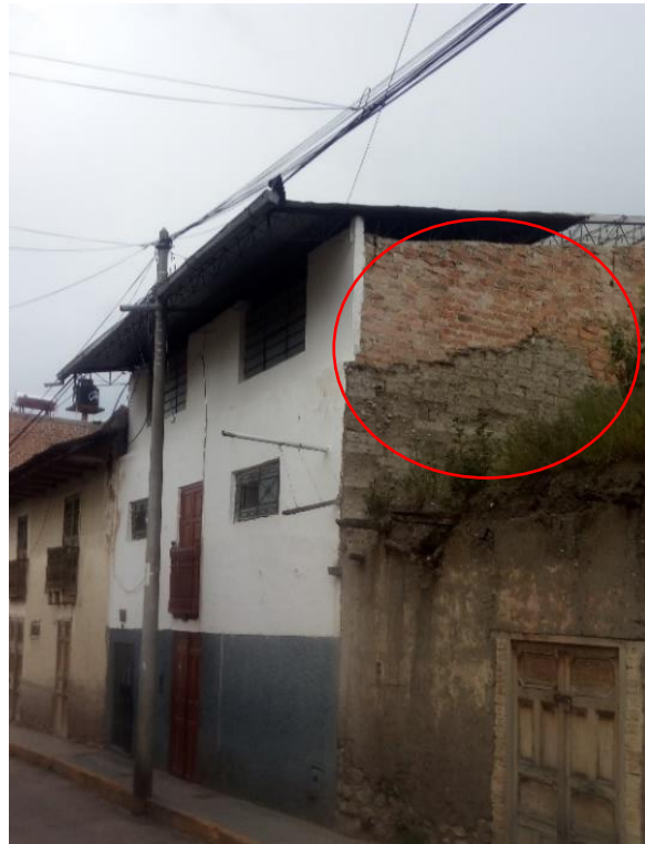
FIGURA 12. Falta de criterio técnico en la combinación de materiales de construcción.
