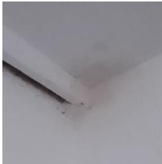
FIGURA 33. Detalle de presencia de humedad en techo de la I.E.P. “Nuestra Señora de Fátima”.
