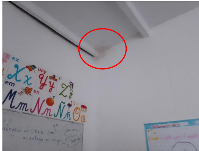
FIGURA 32. Presencia de humedad en cielo raso de la I.E.P. “Nuestra Señora de Fátima”.
