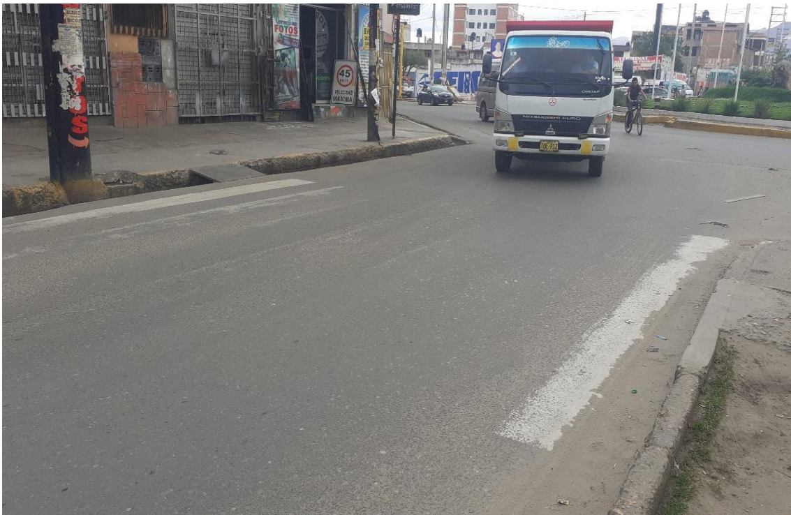
Fotografía N° 24: Pasos de cebra en mal estado en el segmento 1
