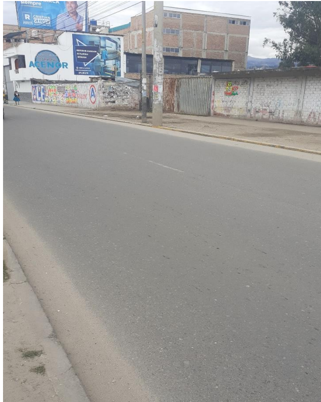
Fotografía N° 19: Estado del pavimento del tramo estudiado
