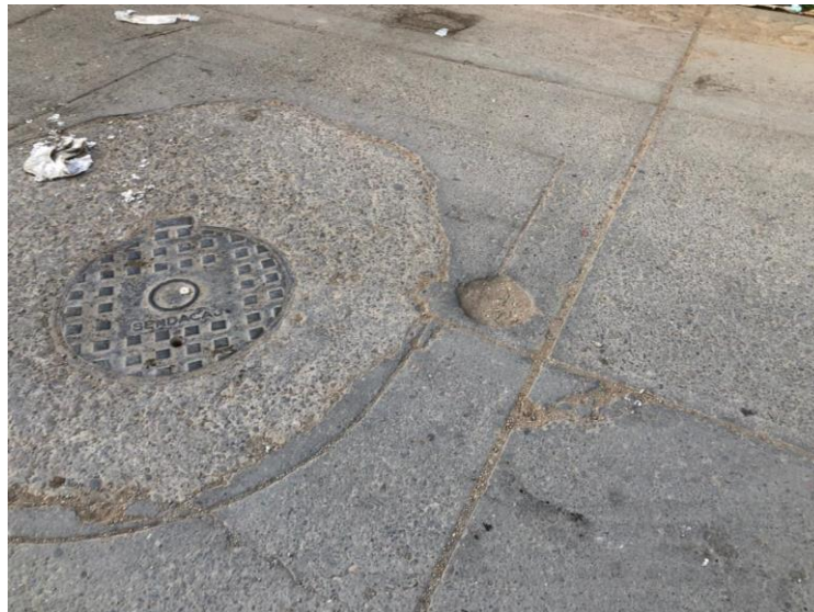
Fotografía N°24:Tramo 03 UM – 06 Descascaramiento de esquina
