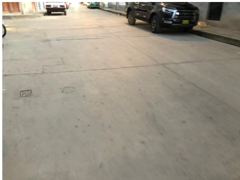
Fotografía N°59:Tramo 19 UM – 53 Popouts con Parcheos grandes
