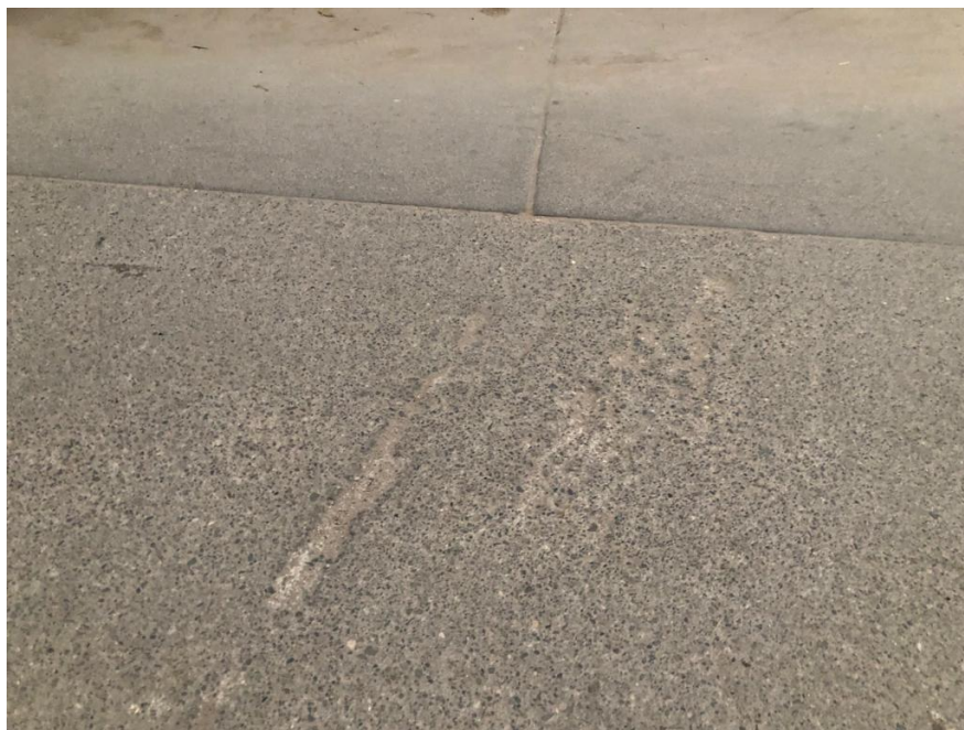
Fotografía N°53:Tramo 16 UM – 48 Pulimento de agregados
