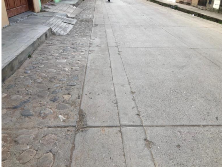
Fotografía N°21:Tramo 02 UM – 03 visibilidad de descascaramiento de esquina y Parcheos grandes a lo largo de toda la vía
