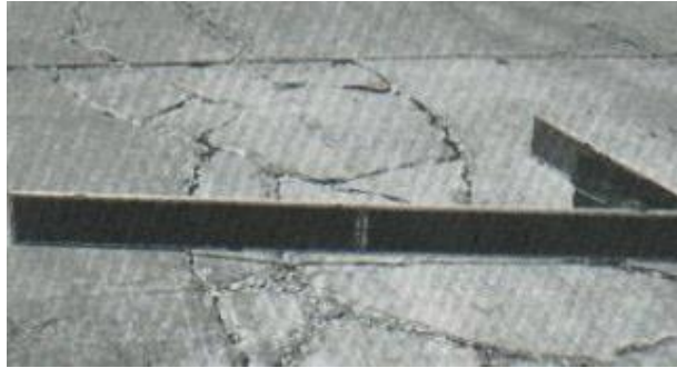
Fotografía N°14: : Vista típica de punzonamiento de alta severidad.
