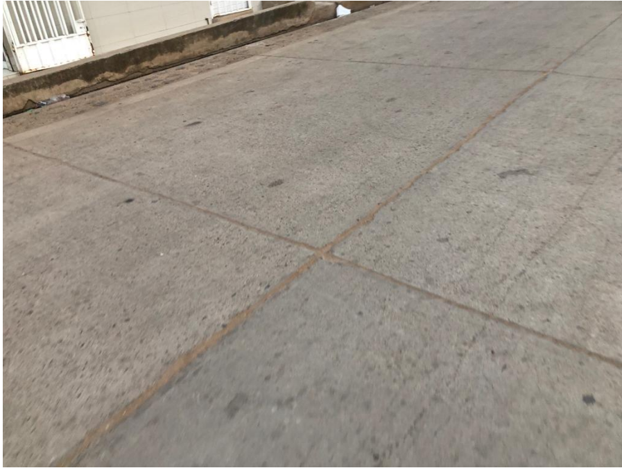
Fotografía N°46:Tramo 13 UM – 39 Pulimento de agregados con popouts
