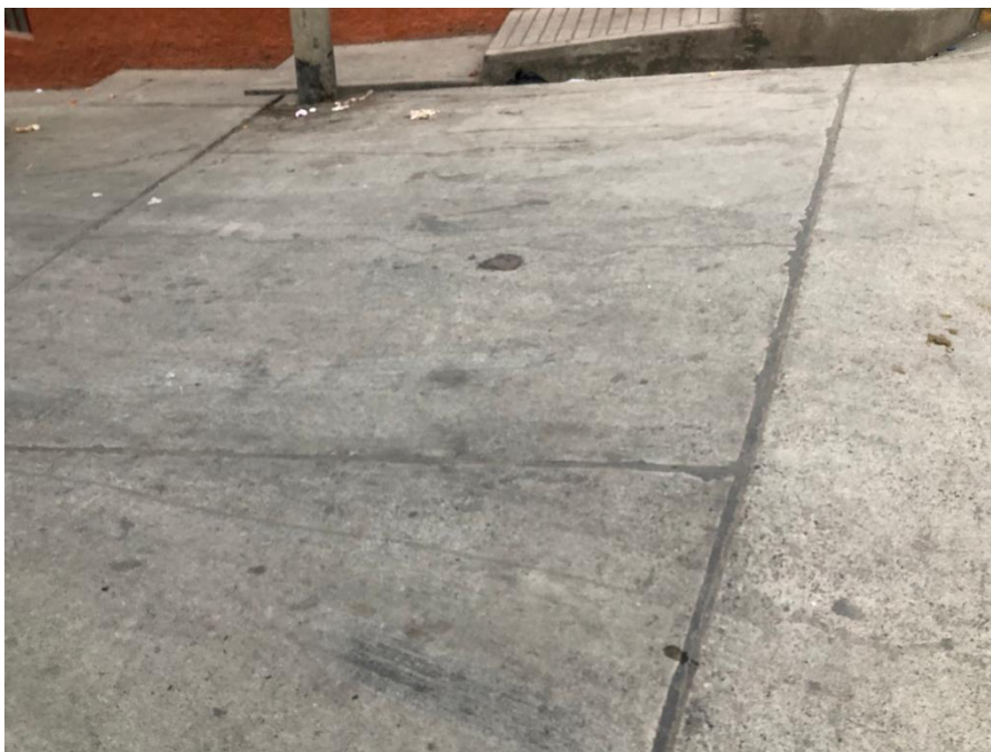
Fotografía N°49:Tramo 14 UM – 42 Popouts con grietas lineales
