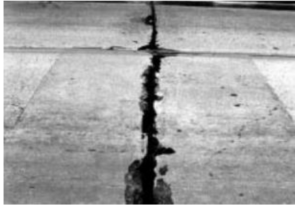
Fotografía N°06: Vista típica de un deterioro del sello de la junta a mediana severidad.
