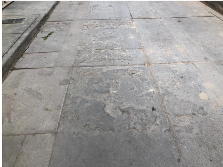
Fotografía N°26:Tramo 04 UM – 08 Desconchamiento, craquelado con Parcheos pequeños y grandes
