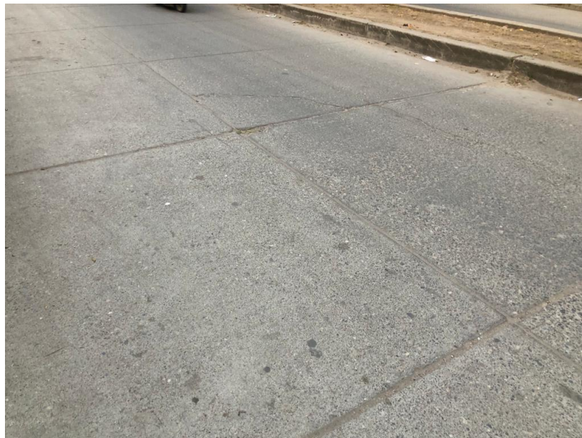
Fotografía N°40:Tramo 10 UM – 28 Pulimento de agregados con grietas lineales
