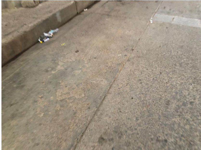
Fotografía N°50:Tramo 15 UM – 44 Pulimento de agregados con desconchamiento además de Parcheos pequeños
