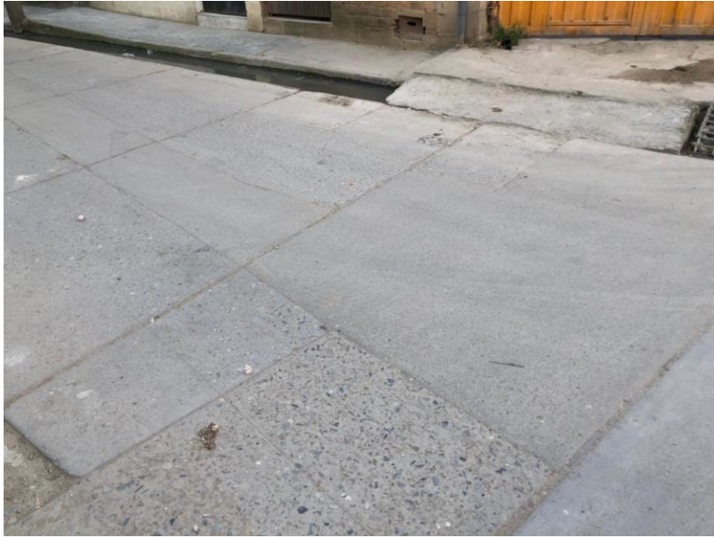
Fotografía N°25:Tramo 04 UM – 07 Parcheos grandes a lo largo de toda la vía
