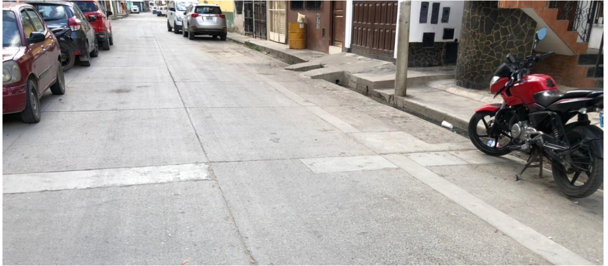
Fotografía N°20:Tramo 01 UM – 01 visibilidad de Parcheos grandes a lo largo de toda la vía
