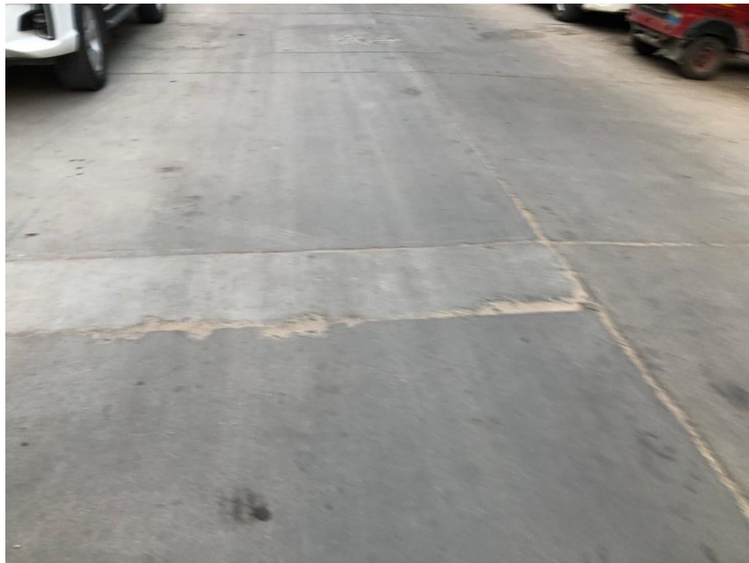
Fotografía N°45:Tramo 12 UM – 37 Parcheo grande con popouts
