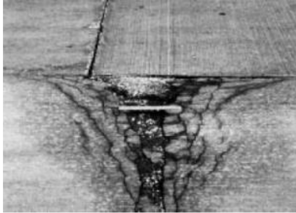
Fotografía N°04: Vista típica de una grieta de durabilidad de mediada severidad
