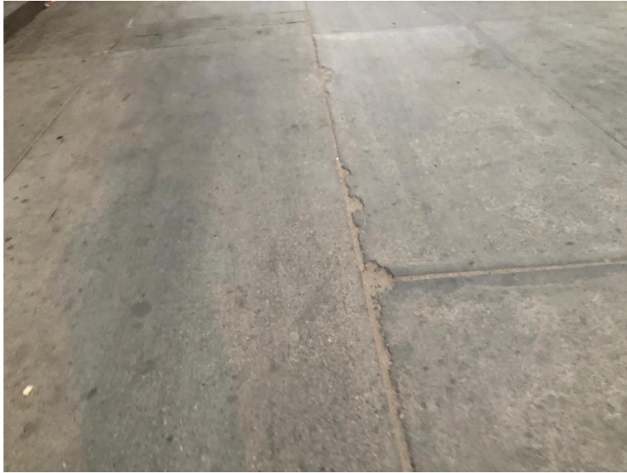
Fotografía N°52:Tramo 16 UM – 47 Popouts con desconchamiento y descascaramiento de junta
