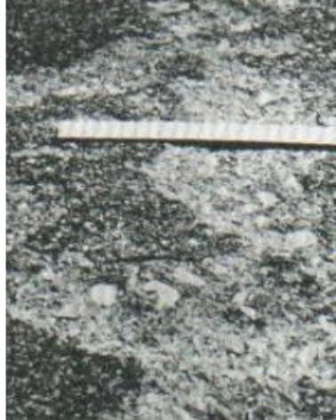
Fotografía N°16: : Vista típica de un desconchamiento / mapa de grietas / craquelado en severidad media.
