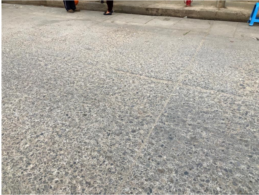
Fotografía N°39:Tramo 10 UM – 25 Pulimento de agregados con Parcheos grandes y pequeños
