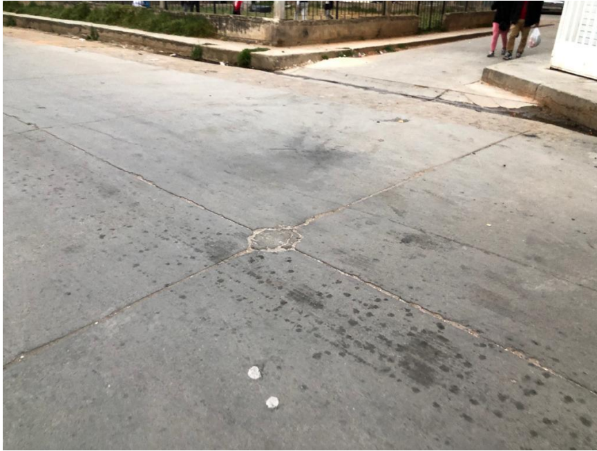
Fotografía N°44:Tramo 12 UM - 36 Grieta de esquina
