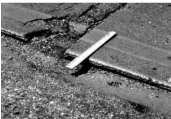
Fotografía N°07: Vista típica de un desnivel carril / Berma de baja severidad.
