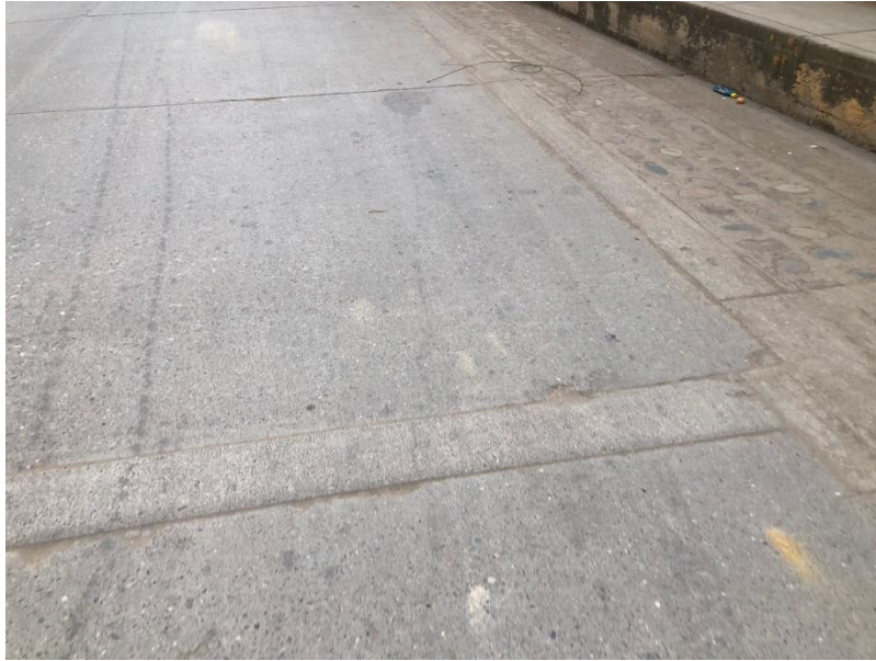
Fotografía N°31:Tramo 07 UM – 16 Popouts con Parcheos grandes y pequeños
