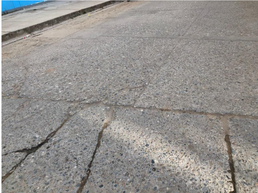
Fotografía N°29:Tramo 06 UM – 14 Pulimento de agregados con grietas lineales
