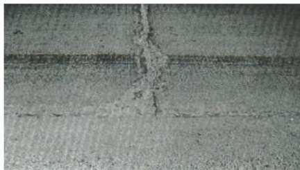
Fotografía N°18: : Vista típica de descascaramiento de esquina de severidad media.
