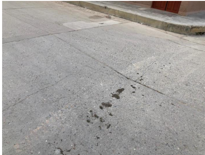
Fotografía N°22:Tramo 02 UM – 04 pulimiento de agregados y Parcheos grandes a lo largo de toda la vía
