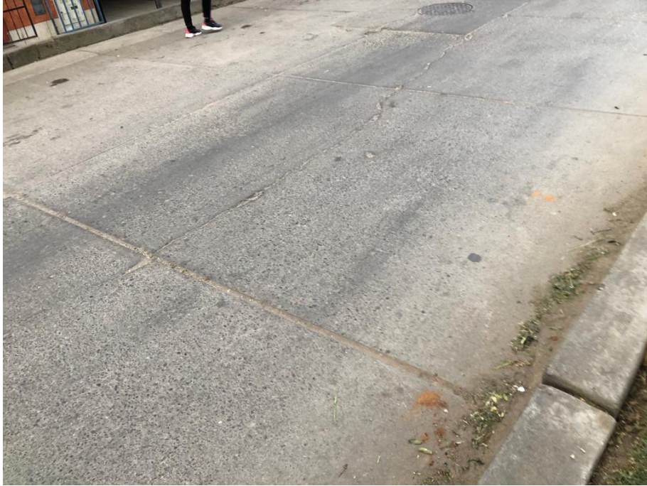
Fotografía N°35:Tramo 08 UM – 22 Pulimento de agregados con grietas lineales
