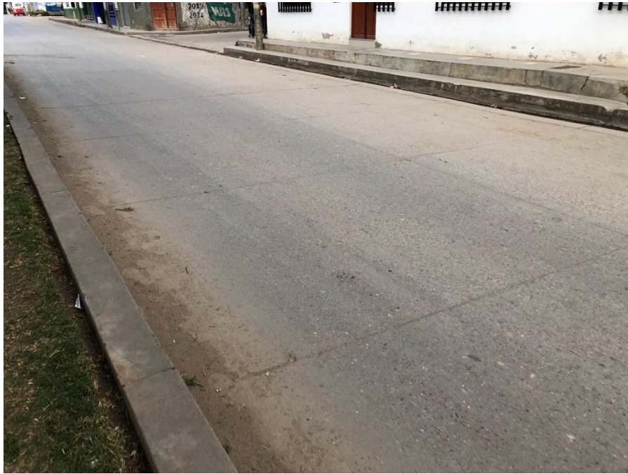
Fotografía N°33:Tramo 08 UM – 20 Pulimento de agregados con parcheo pequeño
