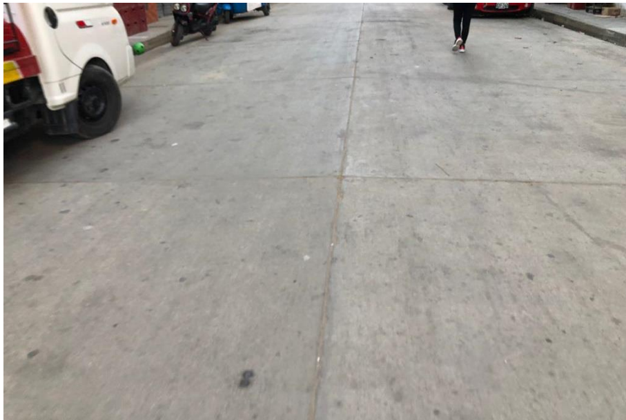
Fotografía N°47:Tramo 13 UM – 40 Vista de popouts
