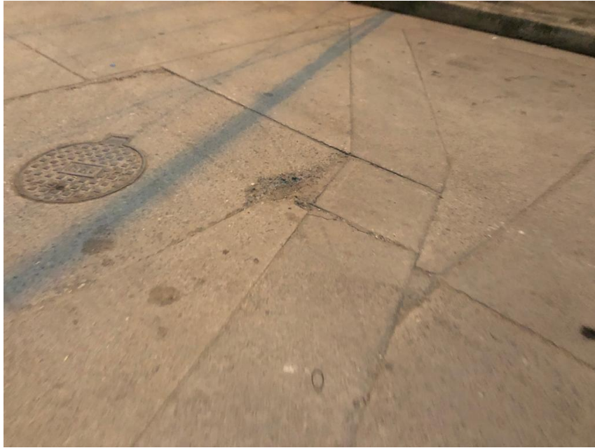
Fotografía N°56:Tramo 18 UM – 52 Descascaramiento de junta a lado del buzón con popouts y Parcheos grandes
