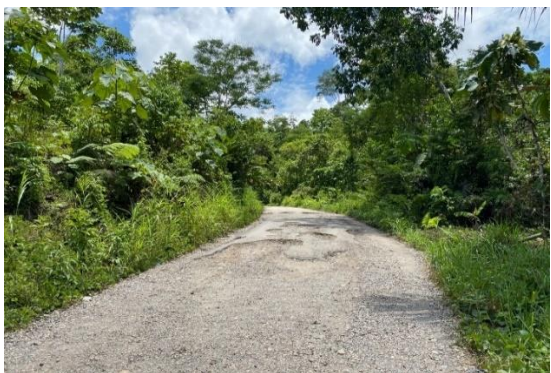
Fotografía 07: Verificación de la vía, en la cual se puede notar el deterioro de la carretera
