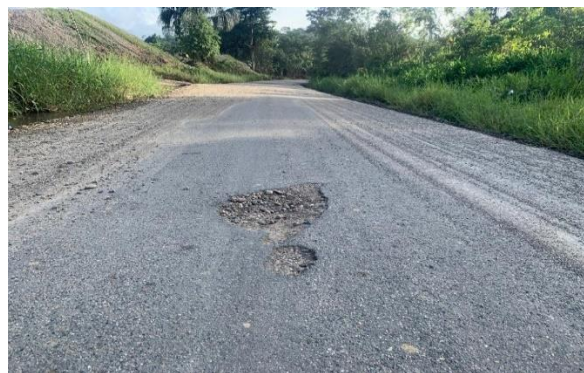
Fotografía 08: Verificación de la vía, en la cual se puede presencia de baches en la carretera
